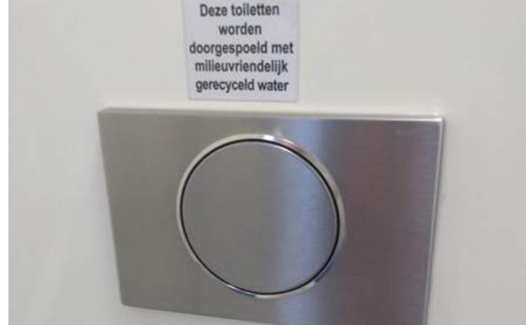
Afbeelding: De toiletten op camping Oranjezon worden doorspoeld met overloop- en filterwater van het openluchtzwembad (foto verkregen via A.J. Pouwer, Camping Oranjezon).
