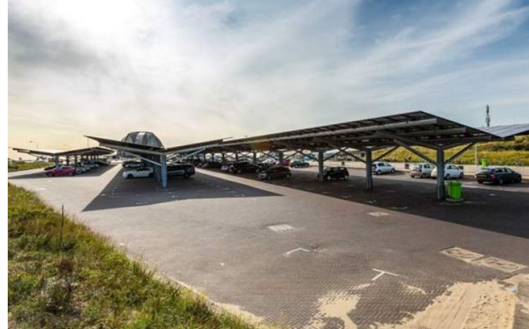
Afbeelding: Zonnepark Carport Bloemendaal (bron: https://www.detechniekachternederland.nl/article/mobiliteit/infratechniek-verkeer/parkeren-onder-zonnepanelen-in-zonnepark-carport-bloemendaal )
