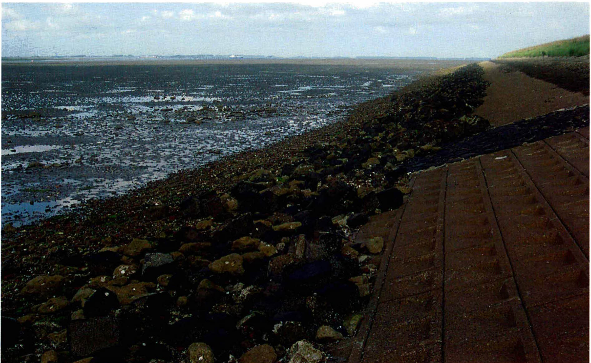
Foto 37 Proefstrook 36, Dortsman: het slik grenzend aan de dijk lijkt over een strook van 20 meter natter en er liggen hier en daar stenen op het slik. Kreukelberm netjes binnen propertes.
