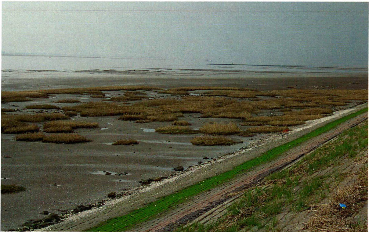
Foto 14 Proefstrook 6: Baalhoek; klein gedeelte duidelijk beter hersteld, waarschijnlijk beter afgewerkt; er zijn in ieder geval duidelijk minder stenen en de begroeiing heeft zich behoorlijk hersteld.
