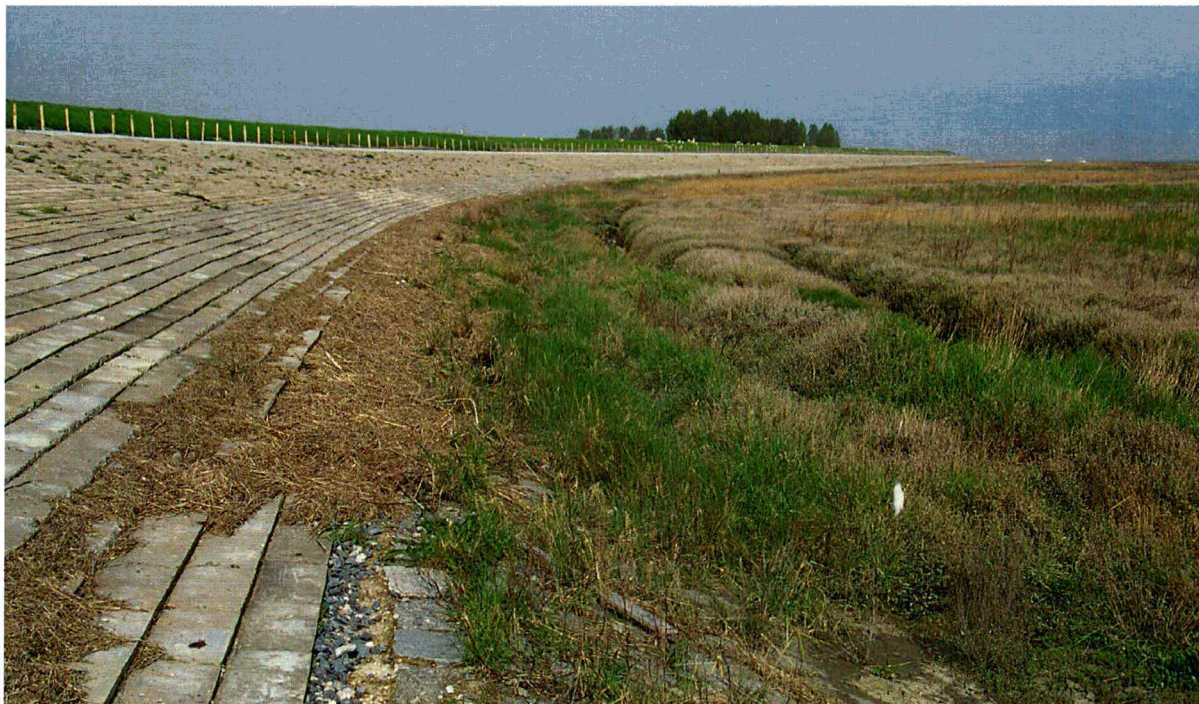
Foto 6 Proefstrook 1: Paulinapolder; de werkzaamheden zijn beperkt gebleven tot de boventafel, hierdoor is er geen werkstrook aanwezig op het schor.
