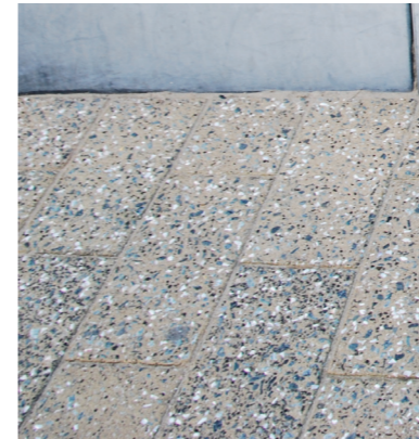
Vloerafwerking van openbare ruimte loopt binnenin door
