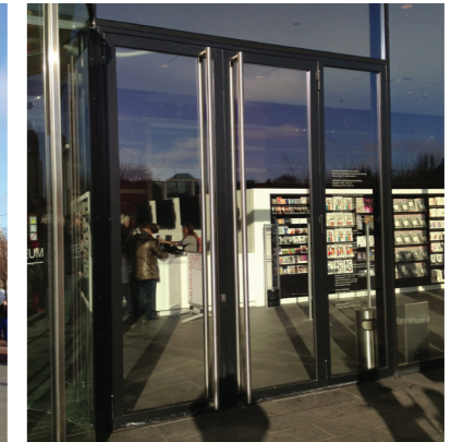
referentie te openen delen in gevel
