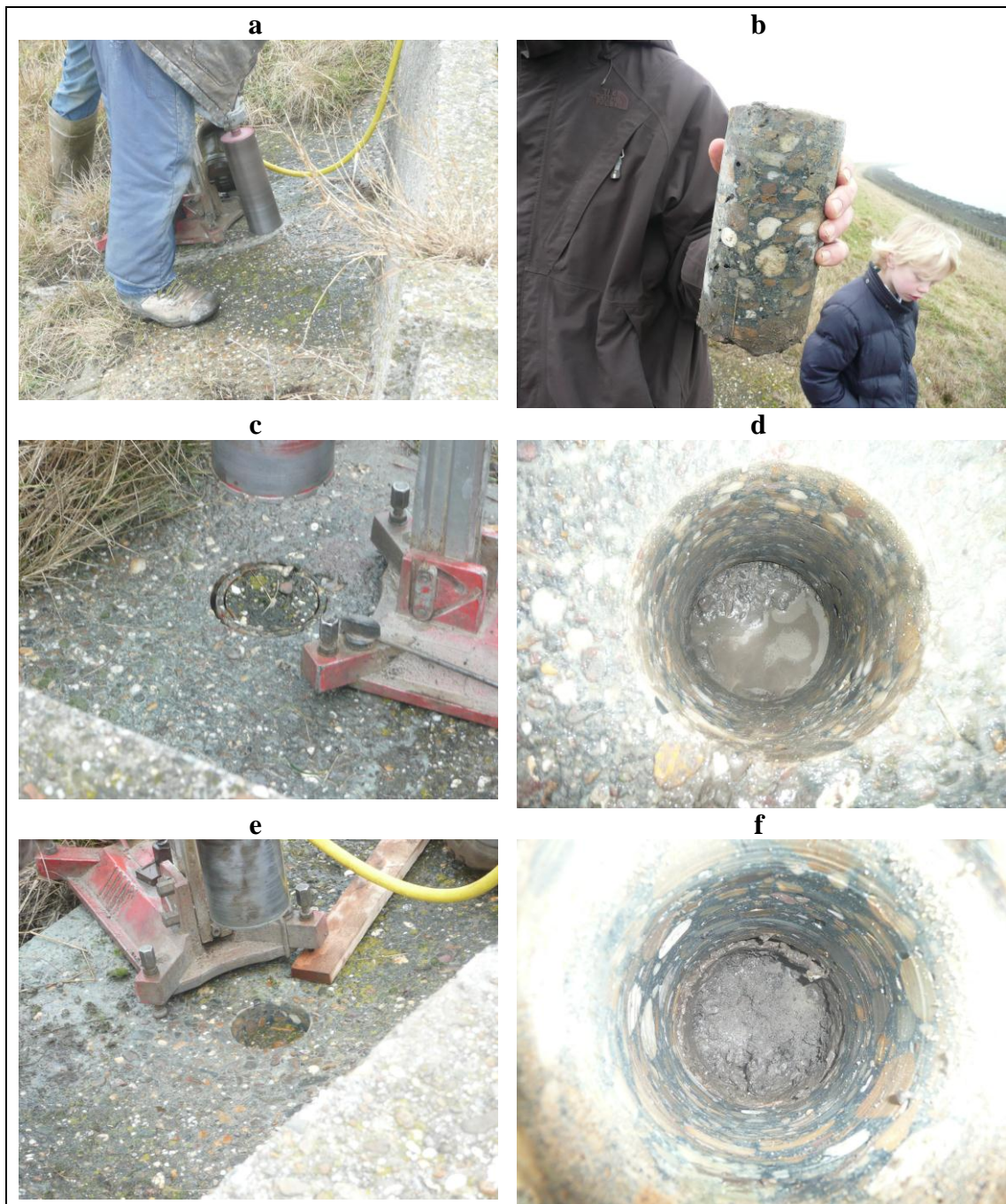
Figuur 4: Een aantal foto's van de verschillende boringen. a) boring op locatie 3 in de Muraltmuur; b) boorkern van de betonlaag. De betonlaag is ongeveer 20 cm dik; c) Boring op locatie 1, boorkern zakt niet weg nadat er door de betonlaag heen geboord is en d) boorwater loopt ook niet weg. Hier is geen holle ruimte aangetroffen; e) boorkern bij boor locatie 3 valt een aantal centimeter naar beneden nadat er door de betonlaag heen geboord is en f) het boorwater is ook gelijk weggelopen. Hieronder werd een holle ruimte aangetroffen.
