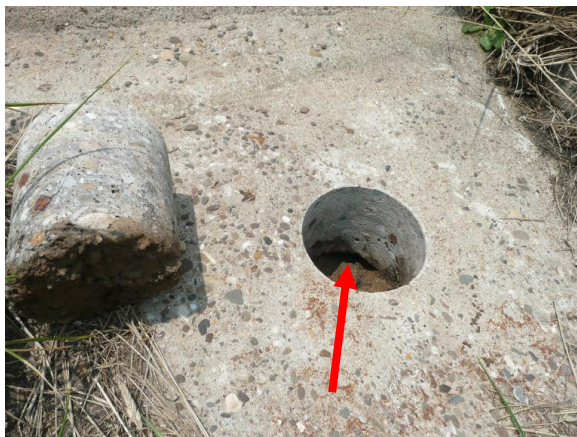
Figuur 12: Boring van dp 46+20 met beperkte holle ruimte richting bovenkant van de muraltmuur (aangegeven door schaduw)
