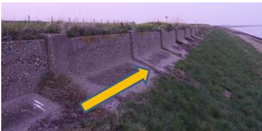
Figuur 1: Muraltmuurtje tussen dijkpaal 53 en 54. De gele pijl geeft aan welk gedeelte van de muurtjes zijn ingemeten. Voor dit project is alleen aan de dijkant ingemeten.
