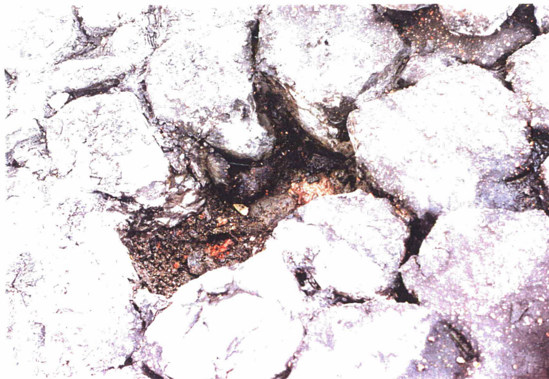
Foto 8 Gat bij km 37. Het filter is ingezand.
