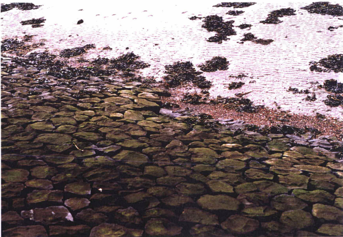
Foto 8 In de bekleding zit onderaan het talud een plateau. Waardoor dit wordt veroorzaakt is niet duidelijk.
