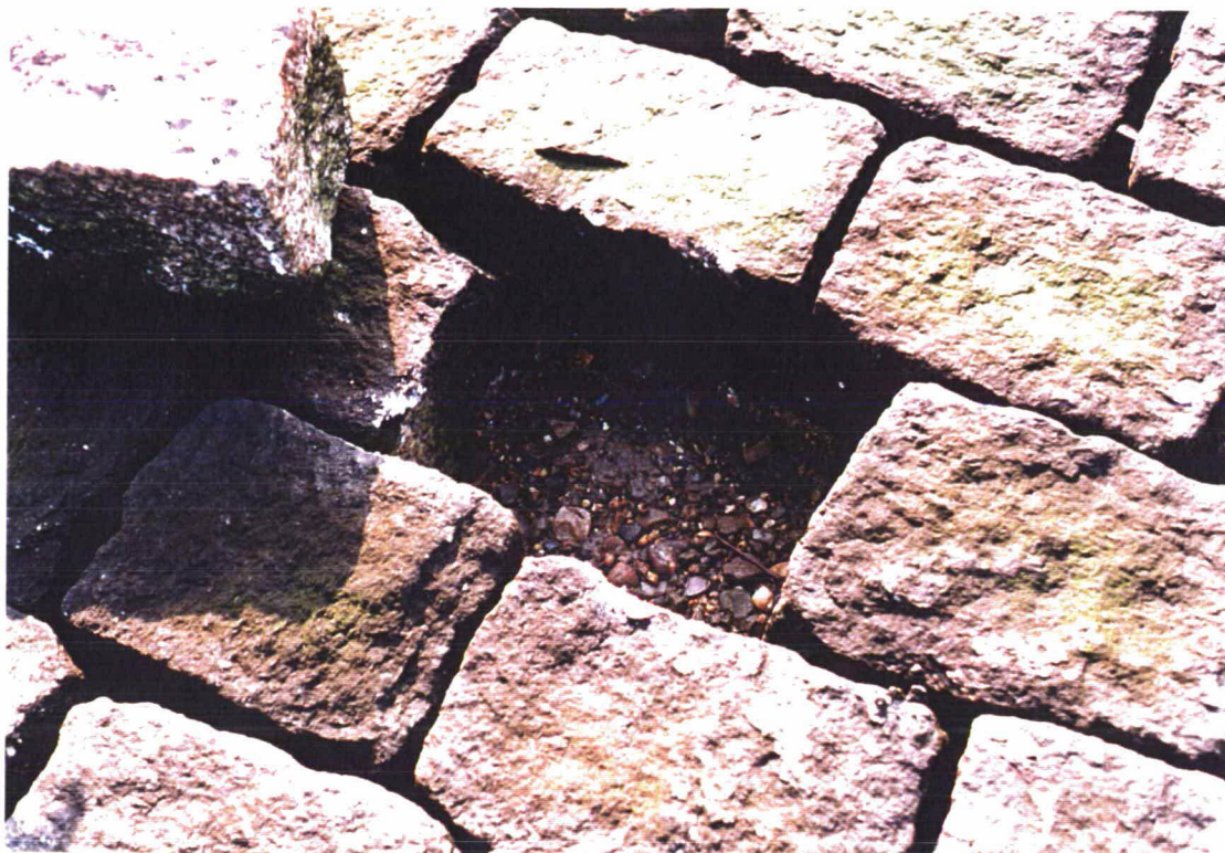
Foto 5: Gat in bekleding 33804. Alleen de bovenkant van het filter is open, hieronder is het filter dichtgeslibd. De spleten tussen de toplaag zijn open.
