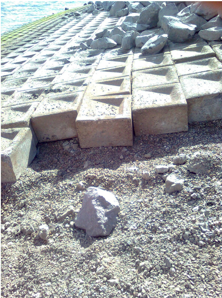
Foto's 7 en 8: Haringsmanblokken op de locatie Roggenplaat die op fijn filter zonder een geotexiel direct de zandlaag liggen
