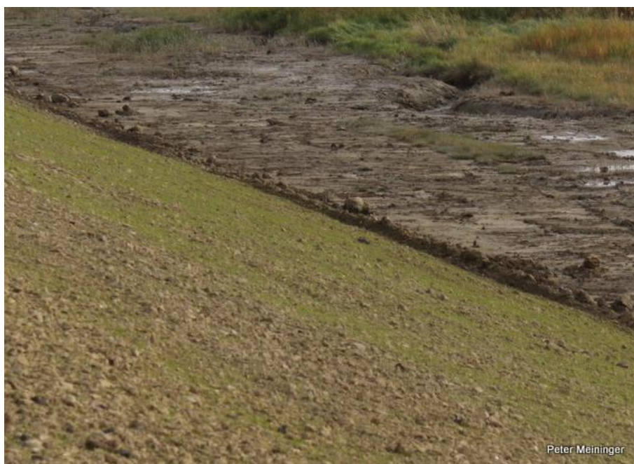
Dijktraject Schor Emanuelpolder. Te verwijderen kleibonken.
