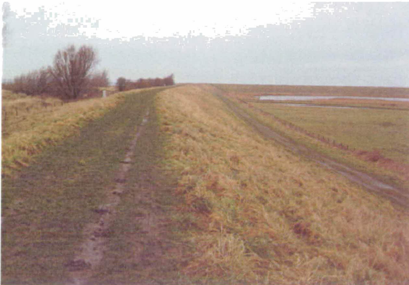
Foto 2.3 De kruin van de dijk tussen dp1900 en dp1905 wordt intensief gebruikt door recreanten (gezien in noord-oostelijke richting). Een berm aan de buitenzijde (links) ontbreekt vanwege het naastgelegen duinterrein. In de toekomstige situatie is de kruin verhard met een onderhoudspad van asfaltbeton.
