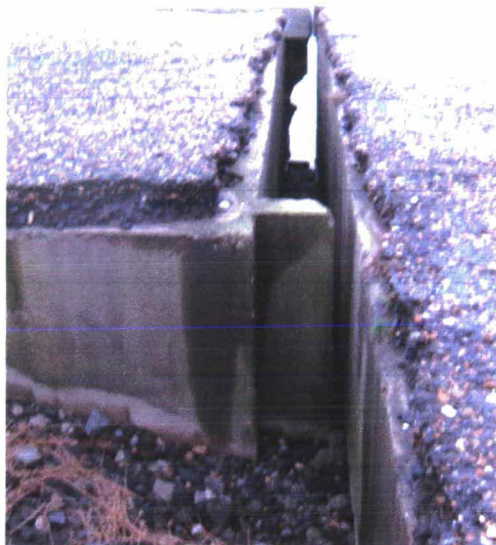
Foto 4: Spleet tussen uitkragende caissons
