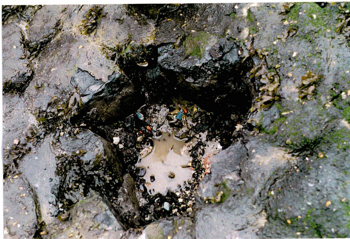
Foto 8 Gat in bekleding laag op talud bij km 35,8
