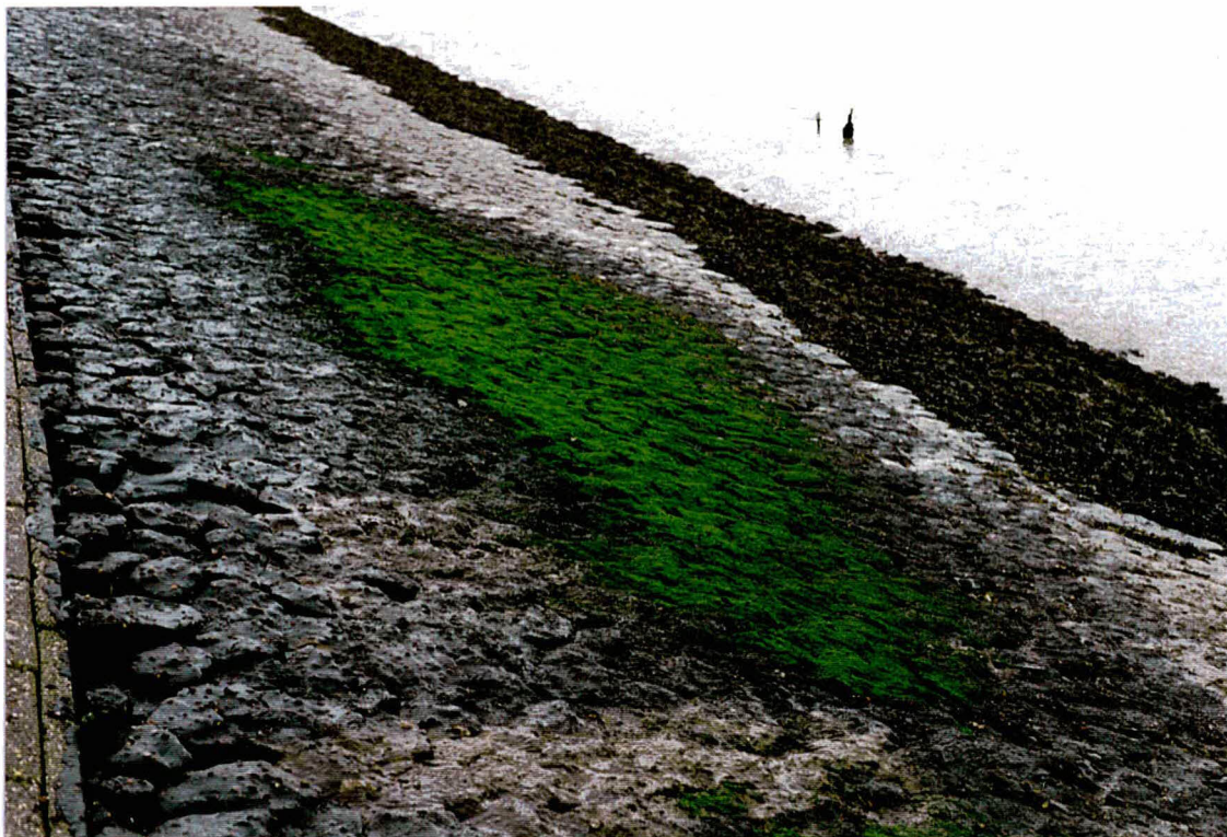
Foto 9 Plek met mosgroei bij km 36. Op het ondertalud onder de blaaswier zitten Doornikse blokken
