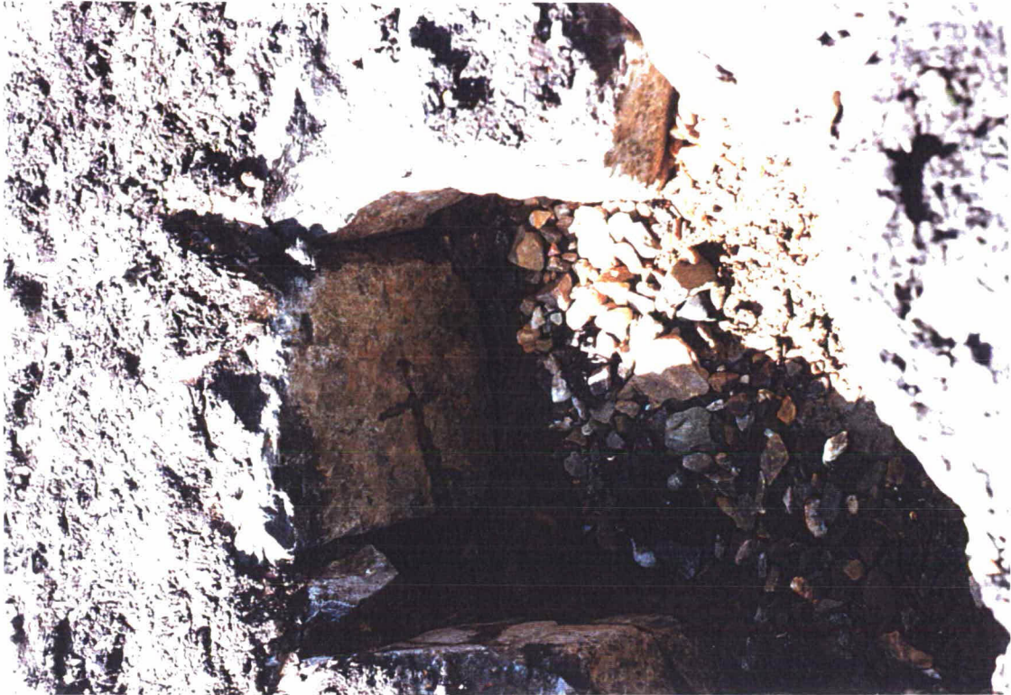
Foto 15 Foto van het gat bij km 39,5. Te zien is een op het oog redelijk schoon steenslagfilter, maar water dat in het gat werd gezet liep maar matig weg.
