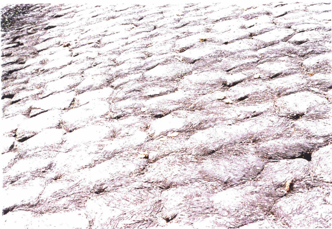
Foto 2 Indruk van de ingegoten basalt. Er is een ruime mate van asfalt aanwezig, met hier en daar een gat tussen de grotere spleten.
