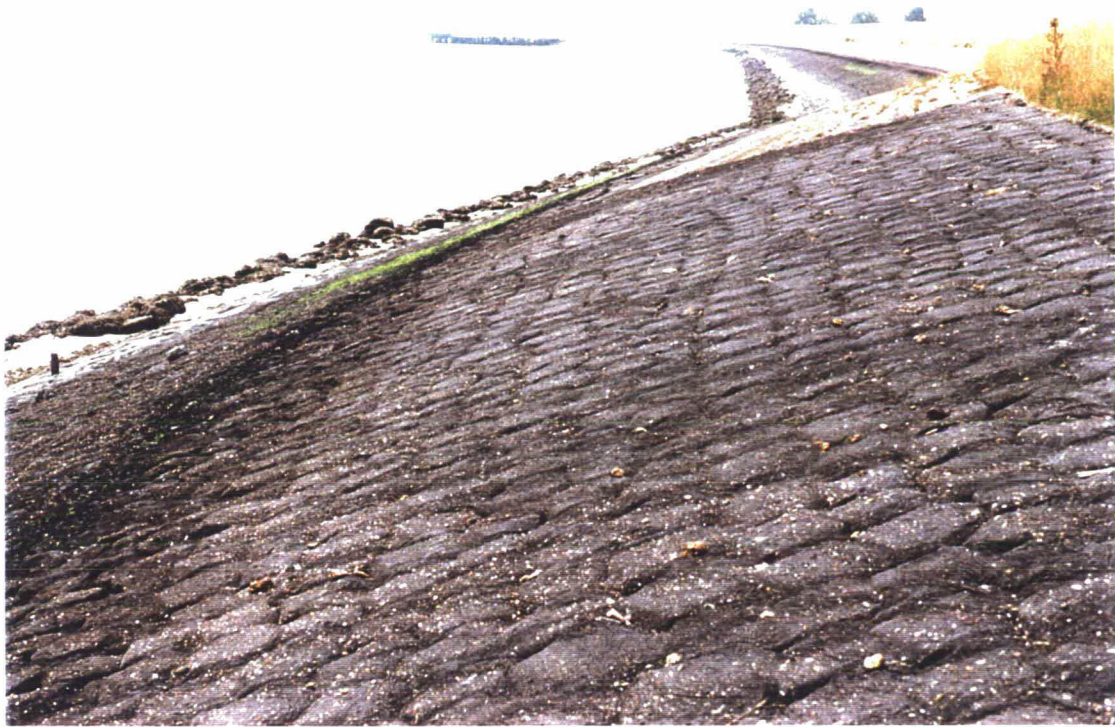
Foto 1 Overzicht van het begin van het vak ingegoten basalt in zuidelijke richting.
