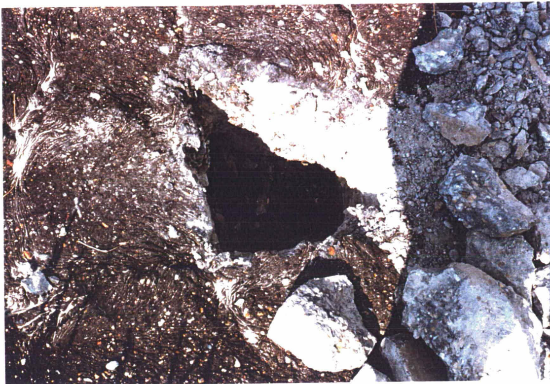
Foto 17 Gat in bekleding 39301 hoog op het talud bij km 39,8.
