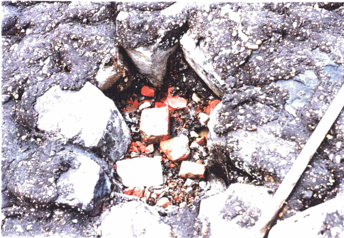
Foto 5 Gat in de bekleding bij km 38,2. Het puinfilter is door het getij aan het oppervlak schoongespoeld, maar blijkt toch geheel dichtgeslibd.
