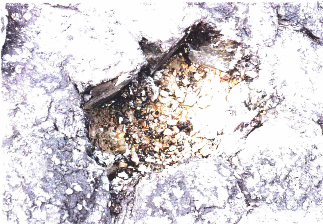
Foto 9 Gat hoog op het talud bij km 38,55. Te zien is een steenslagfilter dat is dichtgeslibd.
