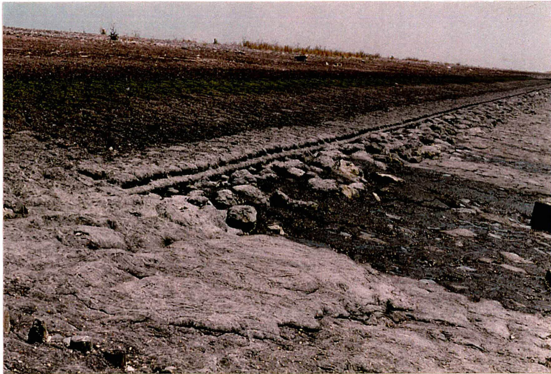
Foto 9 Vochtplekken bij de waterdichte overgang, dp 7 + 70
