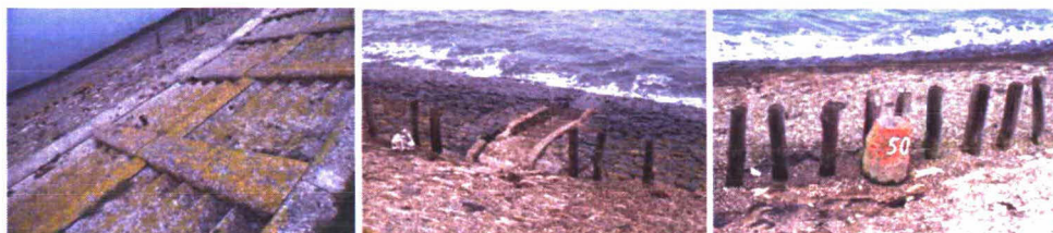
Afbeelding 5, V.l.n.r. Muralglooiing in de buurt van het havenkanaal Zierikzee, Betonnen trapje voor Inlaag Cauwers, Natuurstenen dijkpaal aan de Stoffel of Suzanna's Inlaag.
