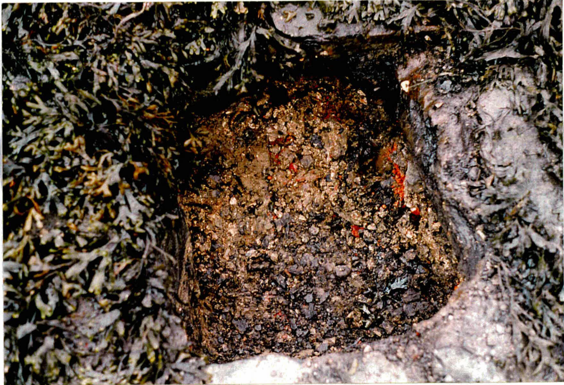
Foto 1 Gat bij dp 203,5
