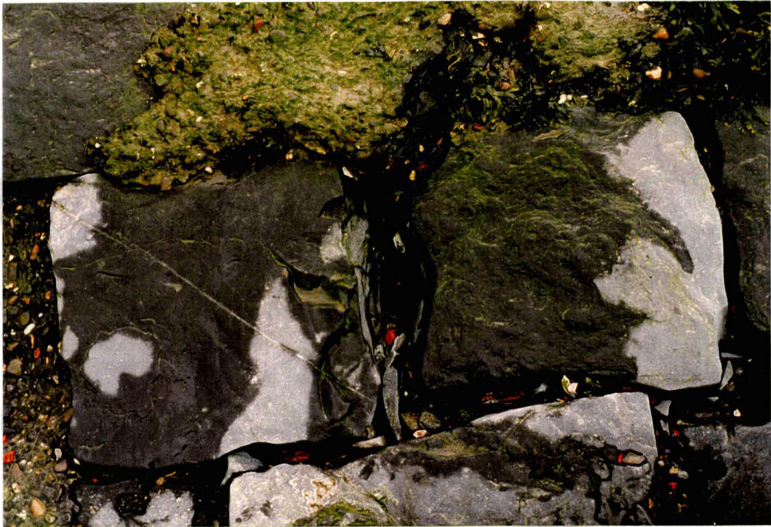
Foto 3 Plaatselijk is de penetratie afwezig maar zijn de spleten wel gevuld met steentjes
