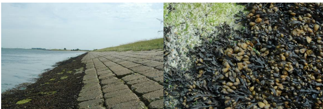
Foto 4.2: Wiervegetatie (o.a. Blaaswier) langs het dijktraject Karelpolder Nieuwlandepolder.
