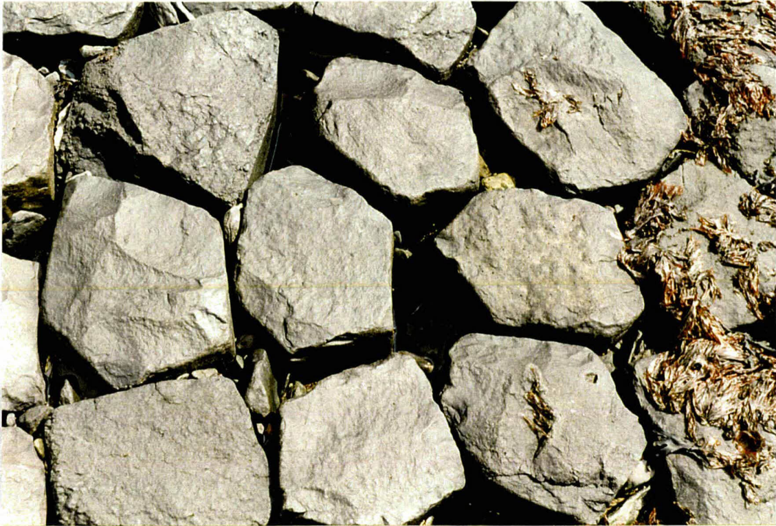
Foto 7 Km 74,3. De stenen boven de getijzone zijn vrij los gezet en er zit weinig materiaal tussen de spleten. Het filter is wel ingezand: er blijft water tussen de spleten in staan.
