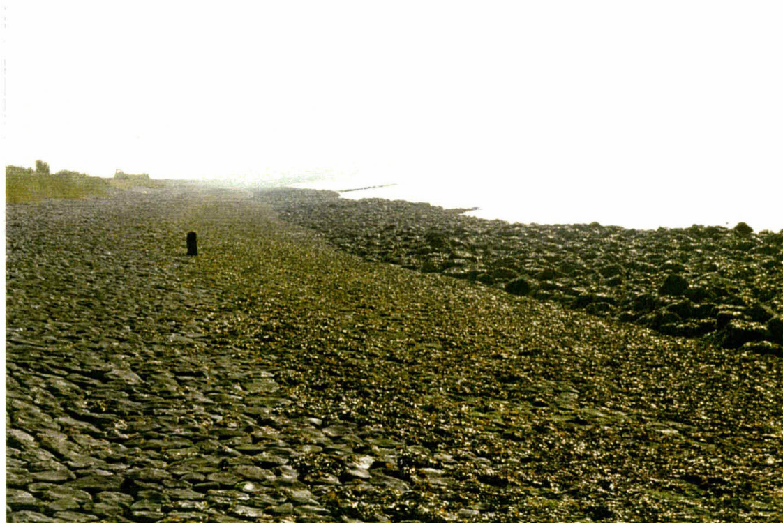
Foto 17 Overzicht van het vak bij km 75,9 in oostelijke richting. De onderkant is hier begroeid met blaaswier.
