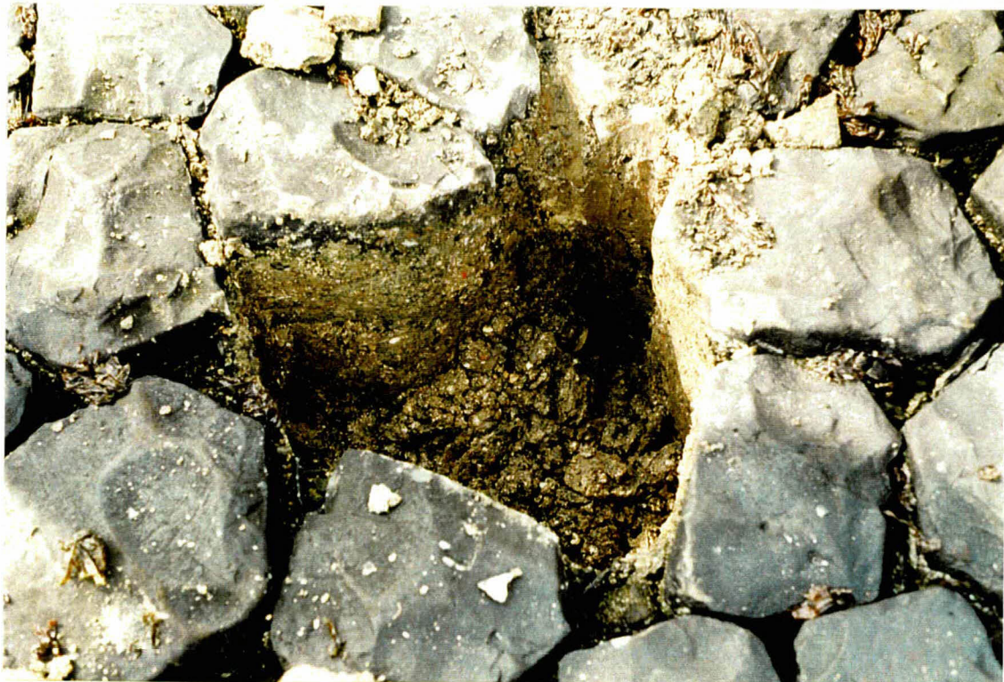
Foto 14 Bij km 75,4 is weer een gat gemaakt. Zowel toplaag als filter zijn dichtgeslibd.
