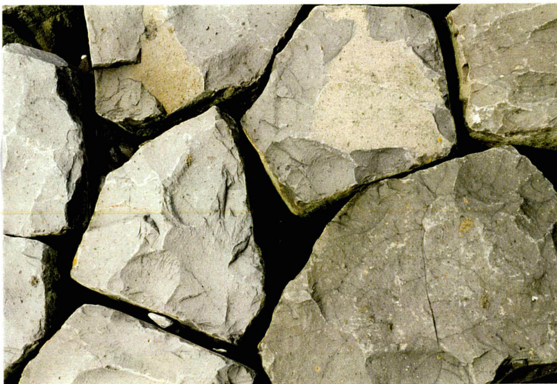
Foto 3 Bij km 73,5 zijn de stenen behoorlijk los gezet. Tussen de grotere spleten zit geen inwasmateriaal meer. De toplaag is hier niet ingezand.
