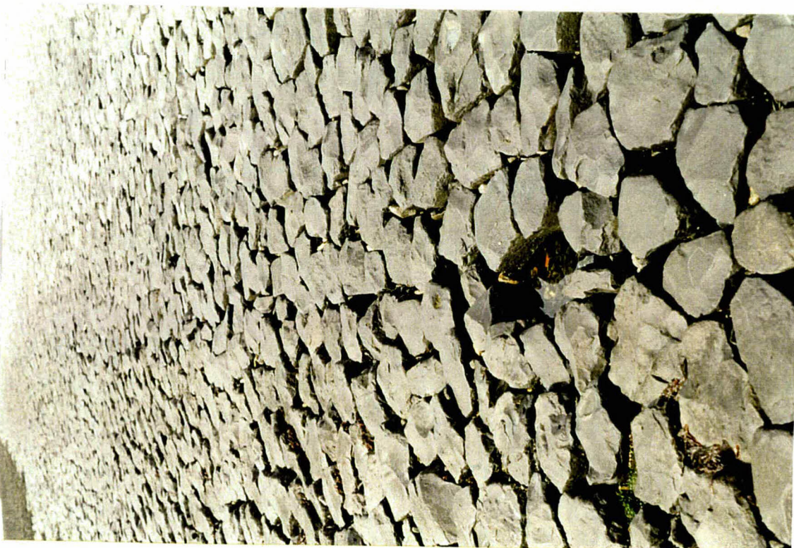
Foto 4 Bij de overgang (km 74) ontbreekt hier en daar een steen.
