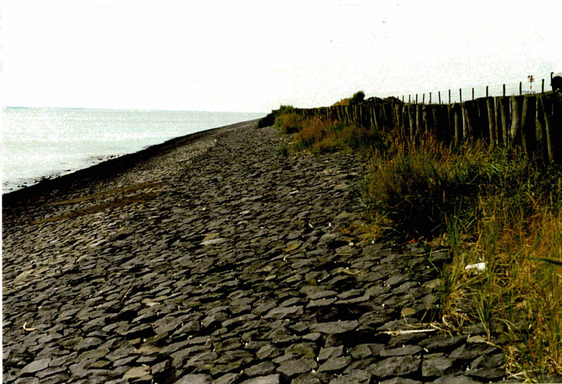
Foto 6 Reparatieplekken midden op het talud. Ook hier laat de kleur van de basalt zien dat er drie stroken zijn aangelegd.
