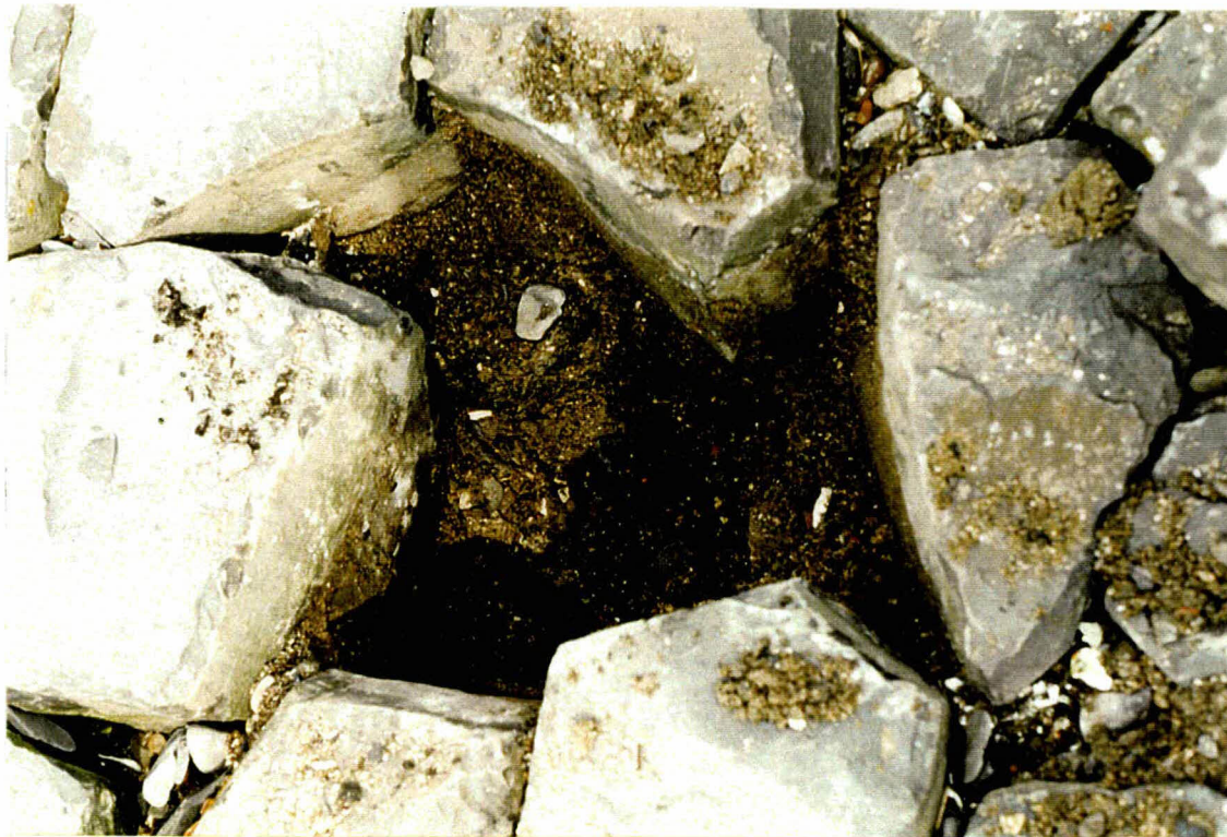
Foto 2 Gat hoog in het talud bij km 73,25. Het filter en de toplaag zijn ingezand.
