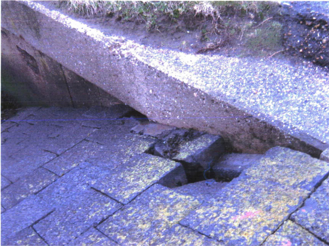
Foto 5: Gloomingschade bij aansluiting ter hoogte dijkspaal 75
