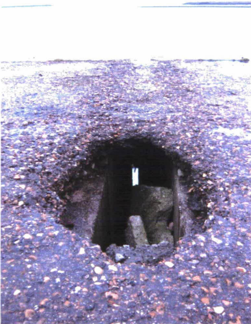
Foto 6: Gat tussen 2 caissons op asfaltplateau
