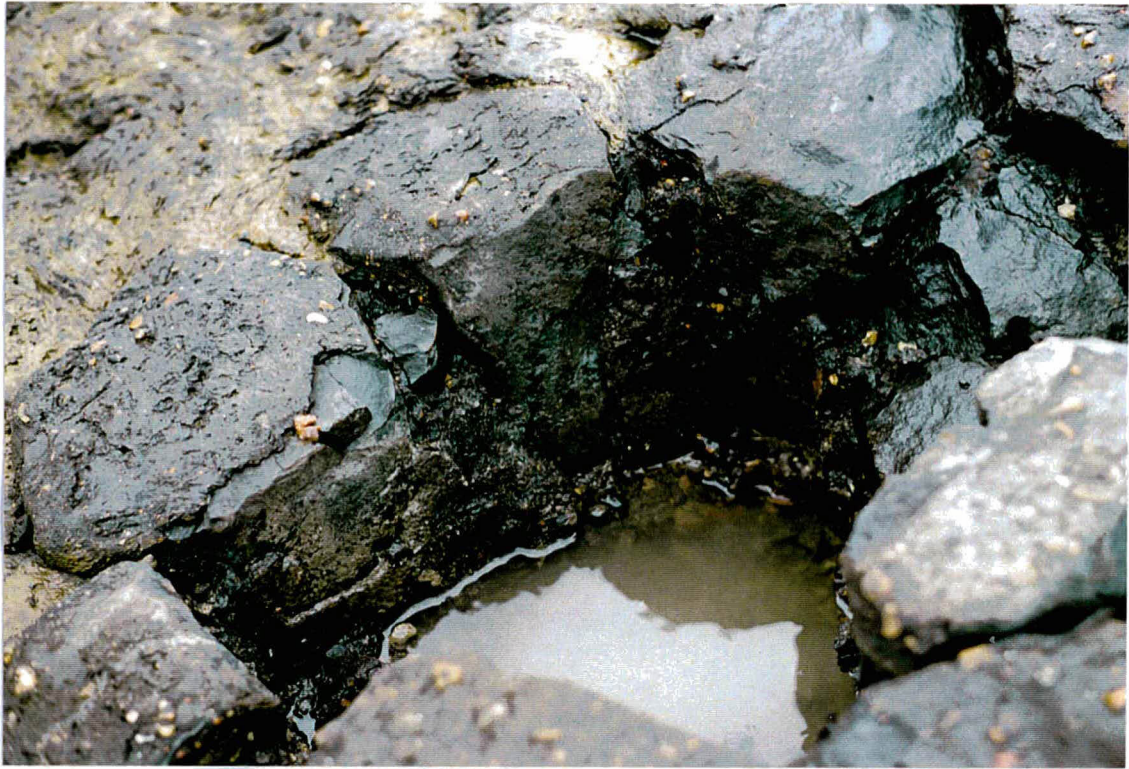
Foto 3 Gat in bekleding hoog op talud bij km 36,4
