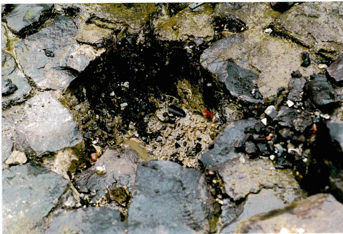
Foto 6 Gat in bekleding laag op talud bij km 36,1
