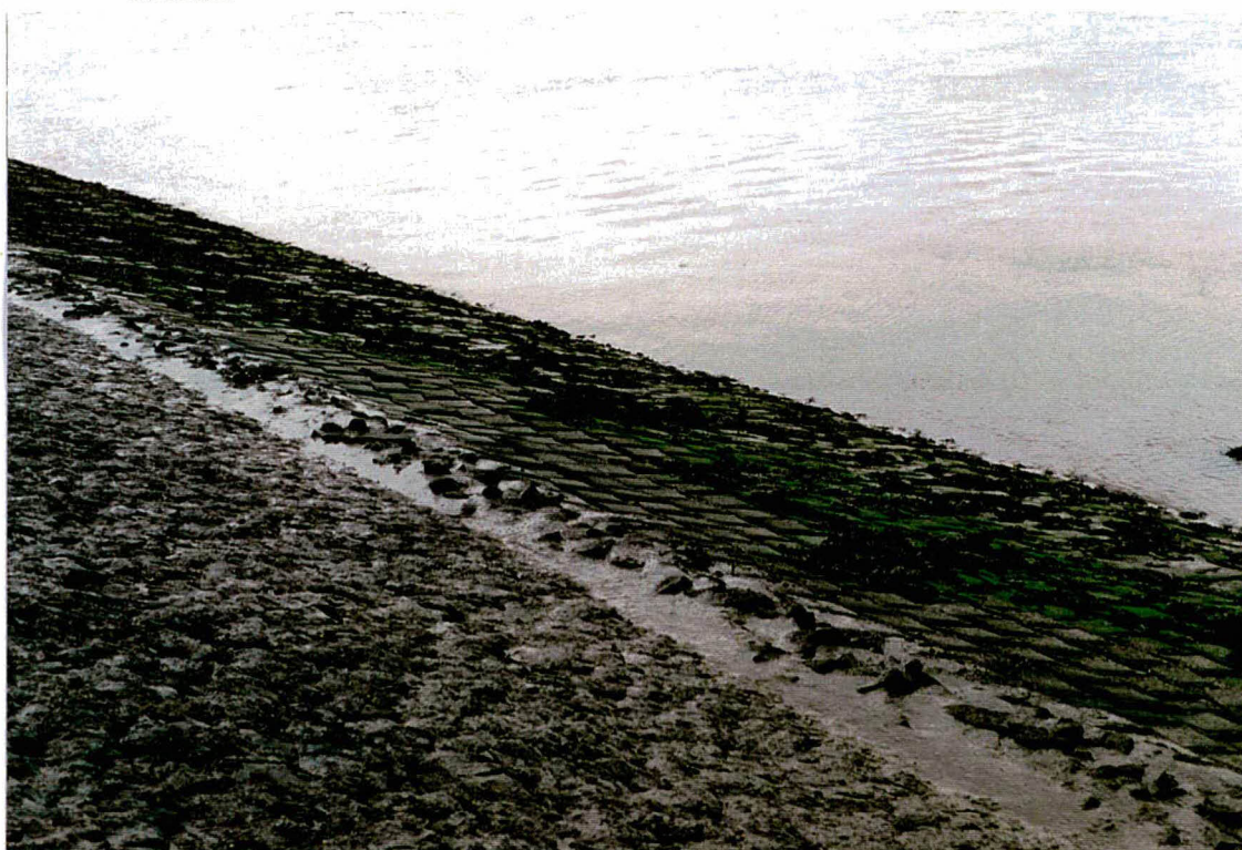
Foto 10 Blokkenmat op het ondertalud. Het oppervlak van de blokkenmat is enigzins golvend. De mat is op filter op de bestaande bekleding gelegd.
