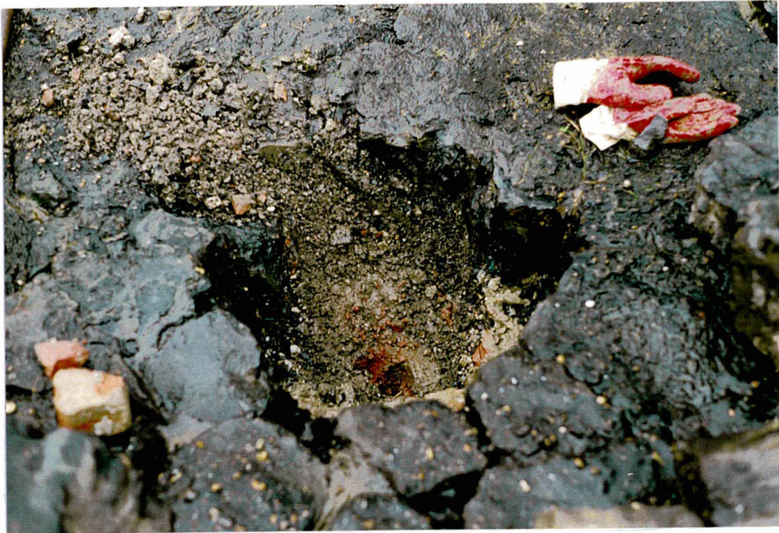
Foto 5 Gat in bekleding hoog op talud bij km 36,1
