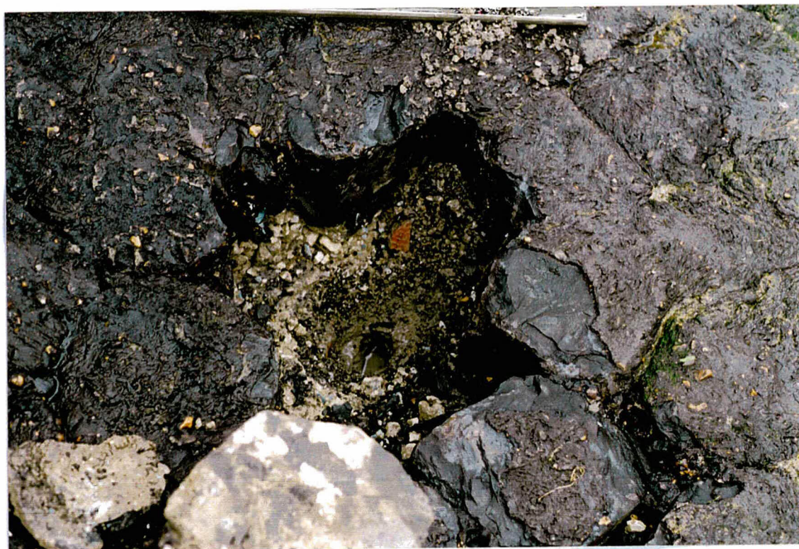
Foto 7 Gat in bekleding hoog op talud bij km 35,8
