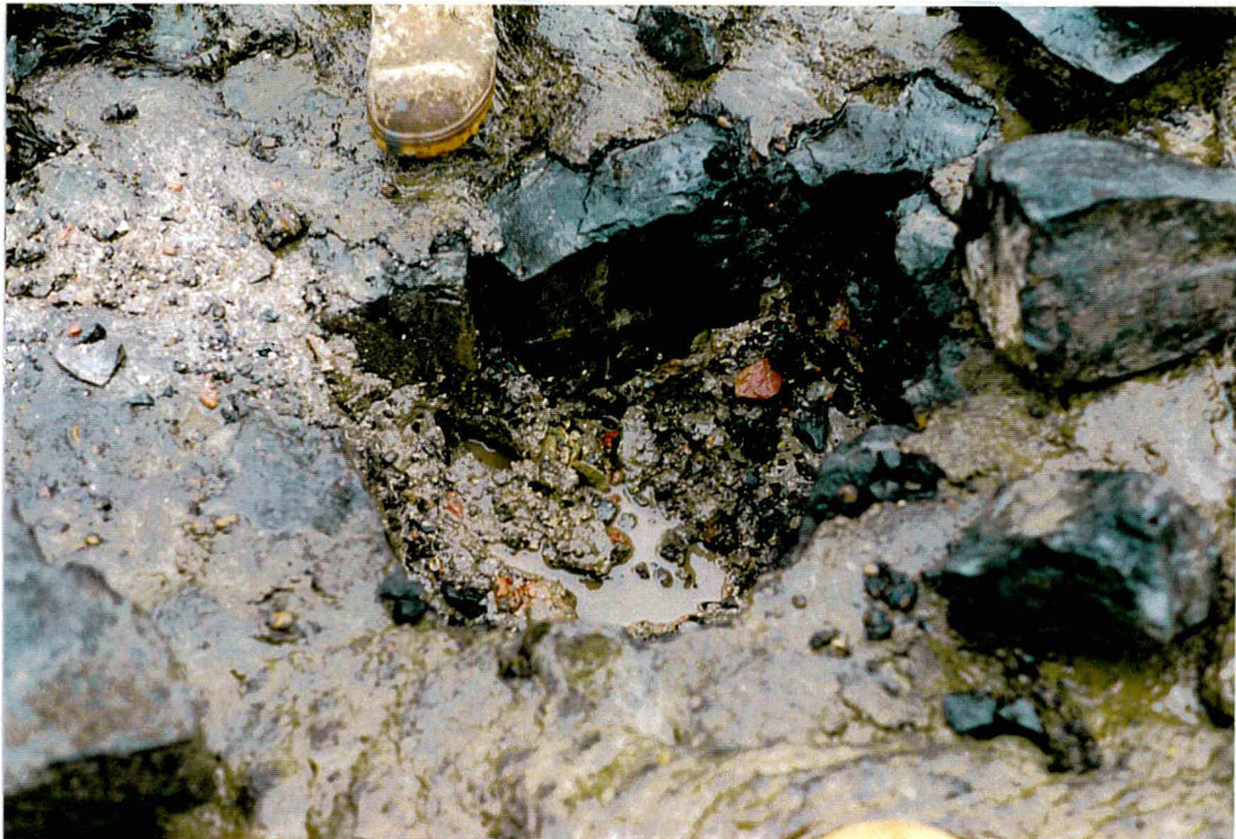
Foto 4 Gat in bekleding laag op talud bij km 36,4
