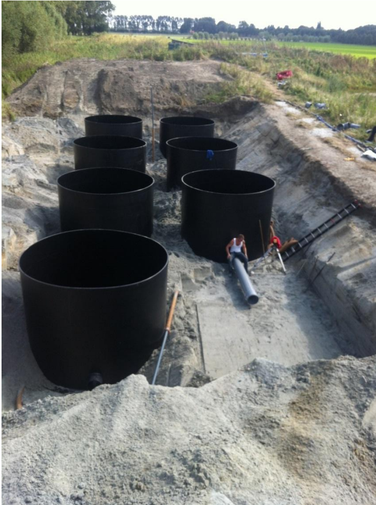
Foto 1. Zeven van de acht tanks in twee rijen opgesteld. Binnen de rij onderling verbonden door grote buizen. In de grond ingegraven voor stevigheid en koeling.
