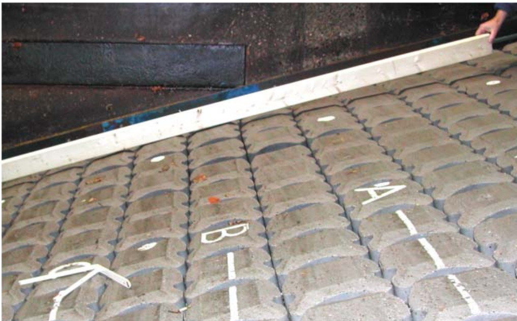
Figuur 4.1, bolling in de bekleding na proef 5251 (serie 1 met Hydroblock)
