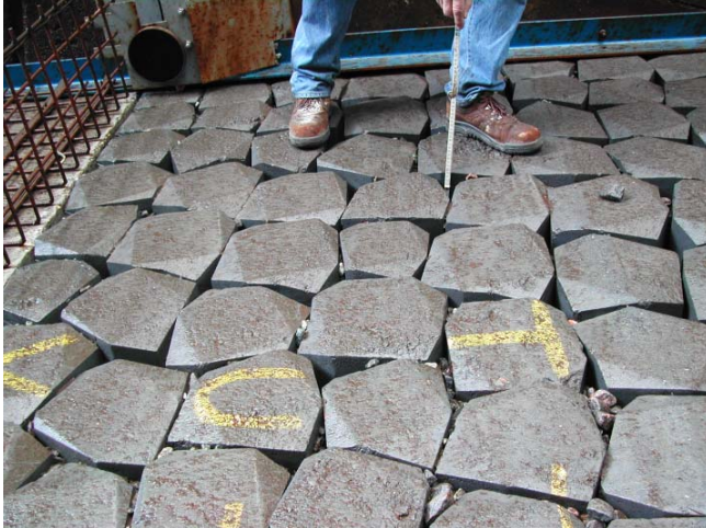
Figuur 3.3 Erosie tot op het geotextiel uit de grote gaten, terwijl in andere openingen nog wel inwasmateriaal aanwezig is.
