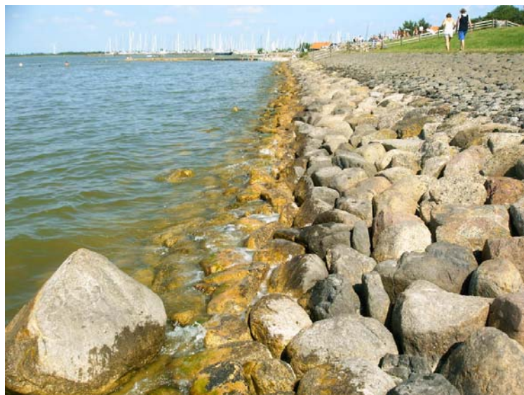
Foto 2.1. Eén steen los op het talud. Deels terug geplaatste steen na schade door kruierend ijs?
