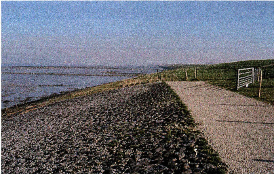
Zeedijk Perkpolder, overgang naar Molenpolder, Zeeuwsch Vlaanderen, 15 februari 2001. Oorspronkelijke zeedijk met begroeid talud, ongeschikt voor broedende plevieren, en onverharde onderhoudsstrook; nieuw beklede zeedijk met aantrekkelijke broedplaats voor plevieren en verharde onderhoudsweg (foto Peter L. Meininger)
