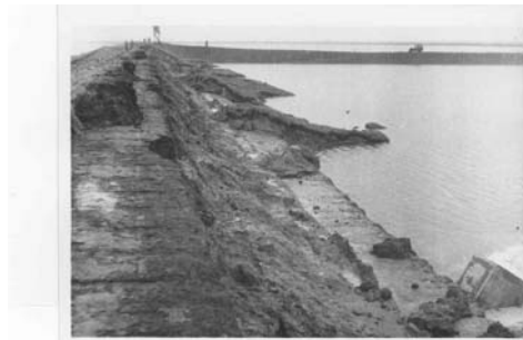
CC-5825 Foto R.W.S. No. 23 Zuid Beveland, Ellwoutsdijk. (Dijkvak 31, Dp. 49 - Dp. 50). Beschadiging van de kruin en het binnentalud. Rechts: Ellwoutsdijkpolder. Zie foto P-1 en foto's R.W.S. No's 25 en 26.
