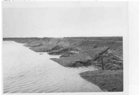
CC-5825 Foto R.W.S. No. 26 Zuid Beveland, Ellwoutsdijk. (Dijkvak 31, Dp. 50 - Dp. 49). Afschuiving van het binnentalud. Links: Ellwoutsdijkpolder. Zie foto P-1 en foto's R.W.S. No's 25 en 23.
