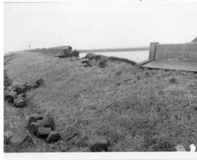
CC-5825 Foto R.W.S. No. 22 Zuid Beveland, Ellwoutsdijk. (Dijkvak 31, bij Dp. 48). Beschadiging van de betonnenmuur. Foto genomen vanaf de buitenberm. Zie foto R.W.S. No. 20.
