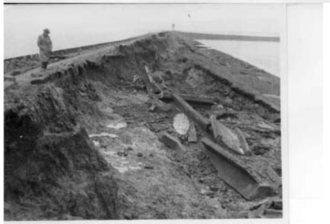
CC-5825 Foto R.W.S. No. 20 Zuid Beveland, Ellwoutsdijk. (Dijkvak 31, bij Dp. 48). Beschadiging van de betonnenmuur, de kruin en het binnentalud. Rechts: Westerschelde. Links: Ellwoutsdijkpolder. Foto R.W.S. No. 22.
