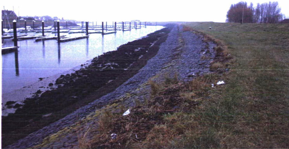
Figuur 2.4 De glooiing van de dijk in de haven van Wemeldinge (deelgebied 3)
