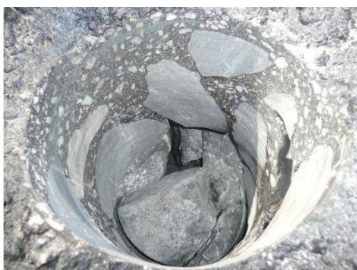
Figuur 2: Gruisophoping onderin de bekleding die door de MIRA techniek is gedetecteerd
