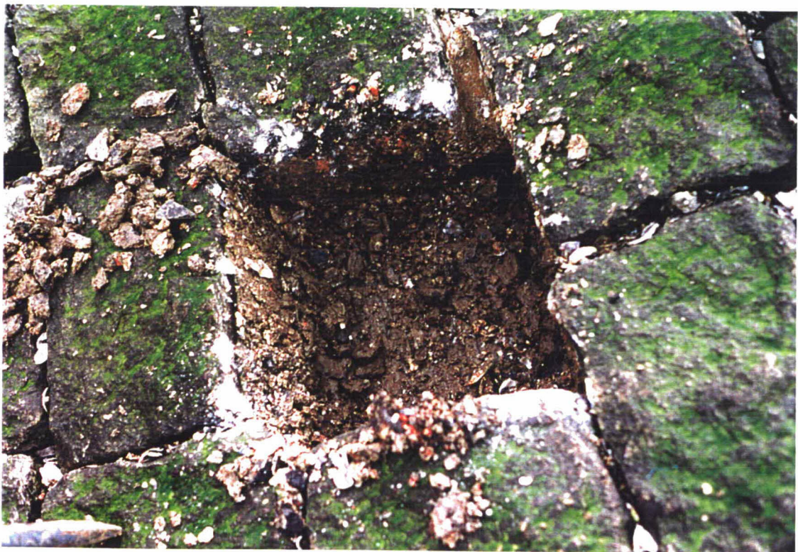
Foto 8 Gat in talud bij dp 260. Het filter van steenslag en de toplaag zijn volledig dichtgeslibd.
