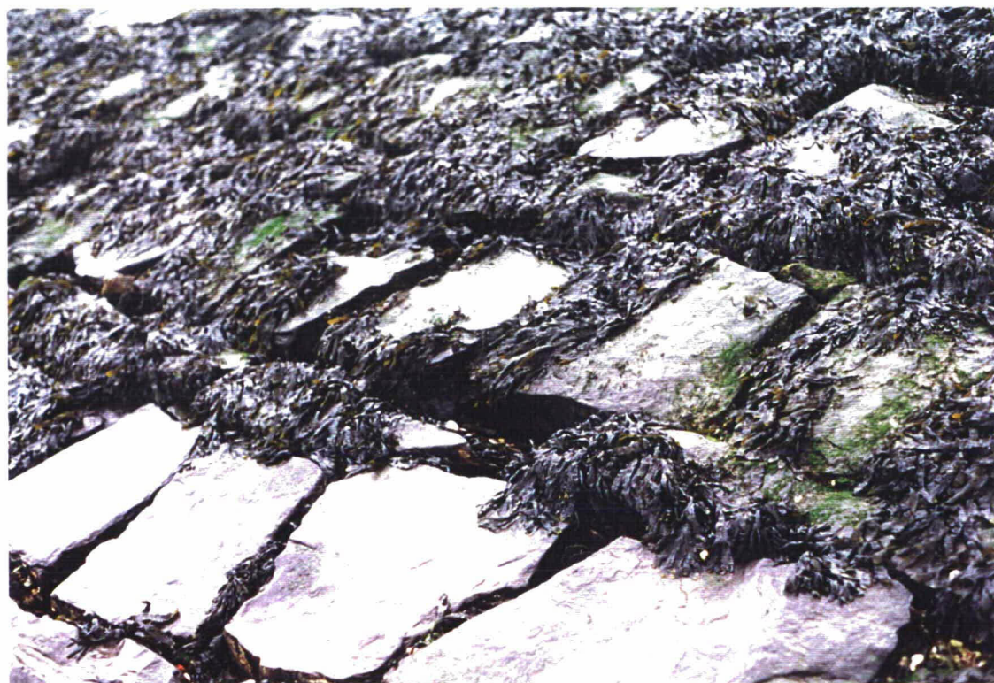
Foto 14 Het oppervlak van de bekleding is erg onregelmatig, er zitten grote gaten tussen sommige stenen en er is een rij blokken op zijn kant gezet.
