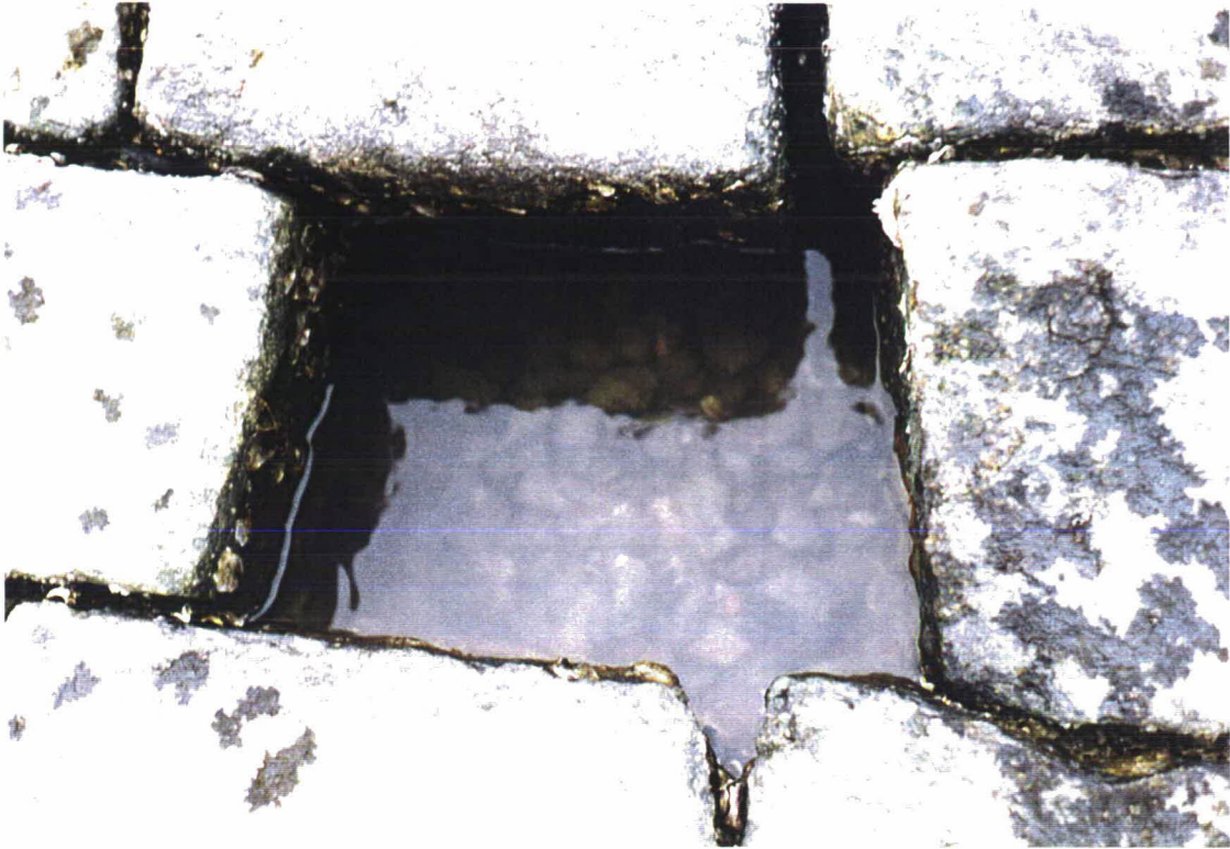
Foto 3 Gat in de bekleding als gevolg van een voorgaande inspectie (dp 259 + 50). Het steenslagfilter is schoongespoeld.
