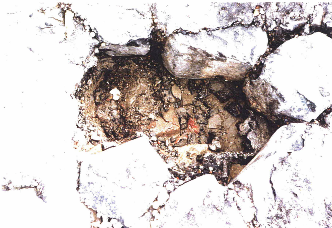
Foto 12 Gat laag op het talud (km 39,05). Het puinfilter is gevuld met fijn slib.
