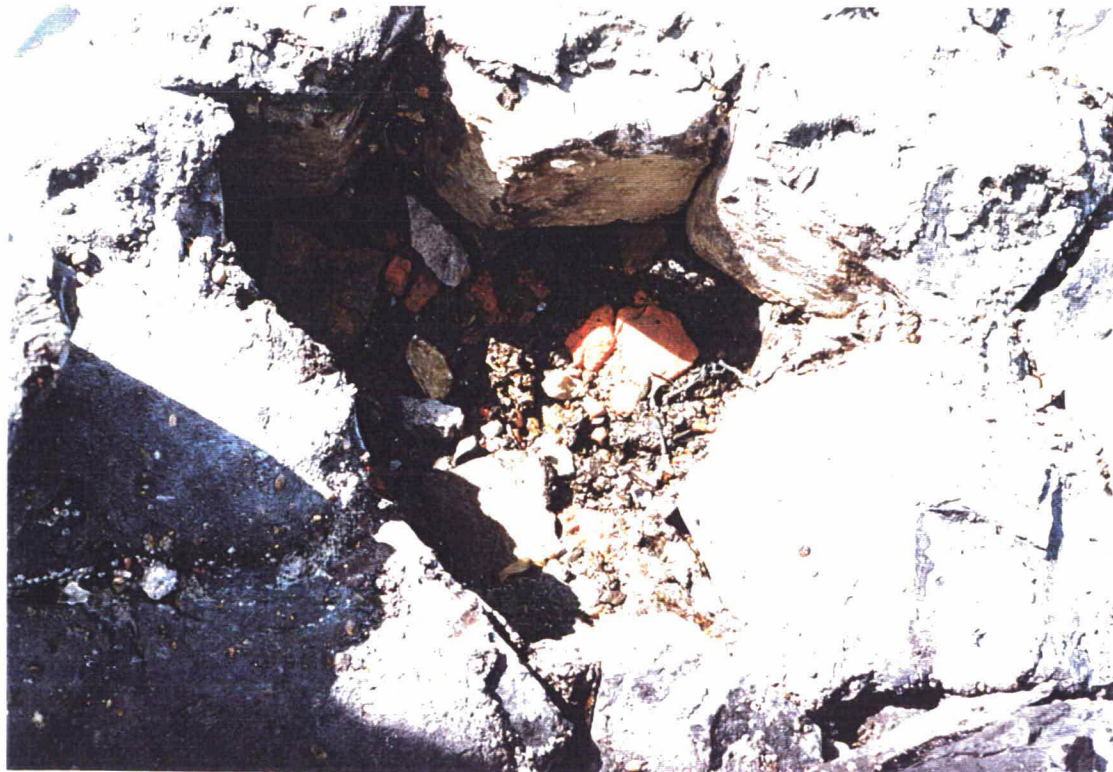
Foto 16 Puinfilter van het gat bij km 39, 7 hoog op het talud.
