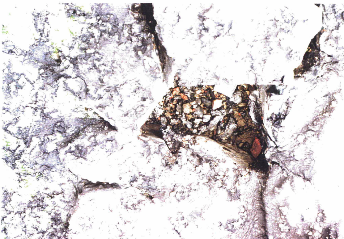
Foto 10 Het laatste gat in bekleding 38103 bij km 38,7, hoog op het talud.
