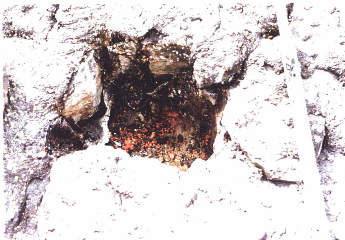
Foto 24 Gat hoog op het talud bij km 39,95. Hier liggen geen slakken maar puin. Te zien is dat de penetratie goed tussen de spleten is doorgedrongen.
