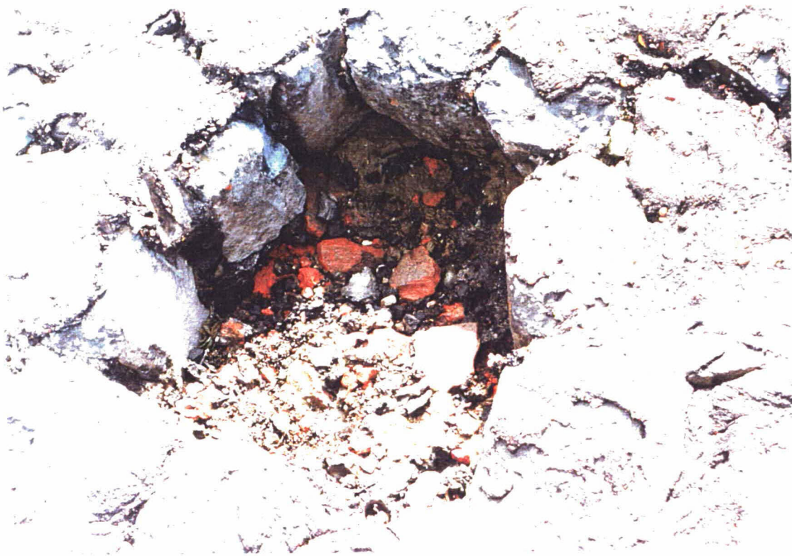
Foto 22 Gat in de bekleding bij km 40,05. Dit gat ligt laag op het talud en is duidelijk dichtgeslibd.
