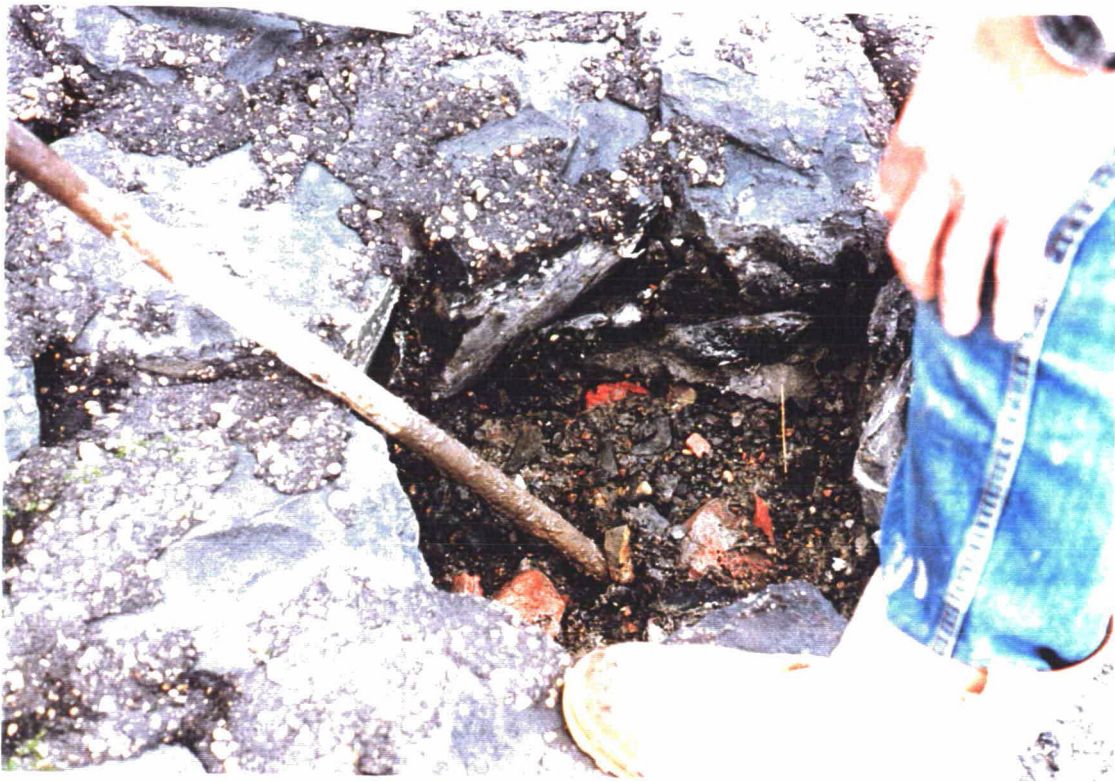
Foto 3 Gat in de basaltbekleding bij km 38,2. Dit is vrij hoog op het talud (NAP + 2,5 m), maar de bekleding is toch dichtgeslibd.
