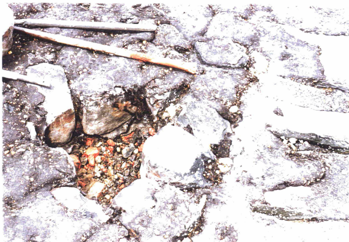
Foto 7 Gat in talud bij km 38,45. Dit gat bevindt zich laag op het talud en is derhalve geheel dichtgeslibd.
