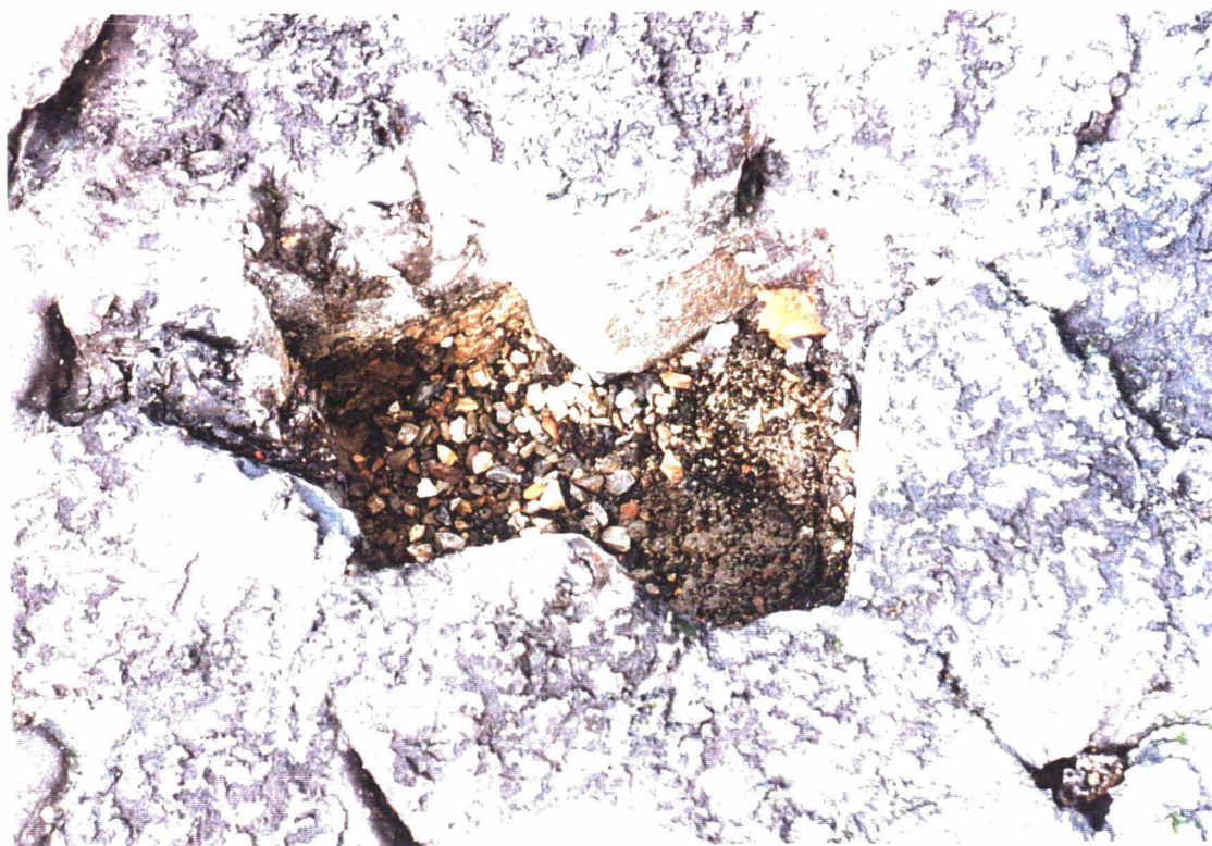
Foto 13 Gat hoog op het talud (km 39,05). Het filter bestaat uit steenslag en zand.
