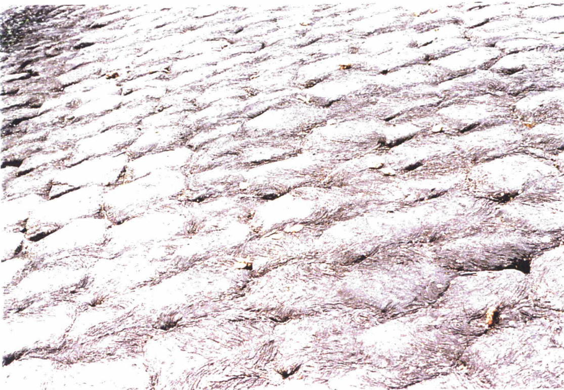
Foto 2 Indruk van de ingegoten basalt. Er is een ruime mate van asfalt aanwezig, met hier en daar een gat tussen de grotere spleten.
