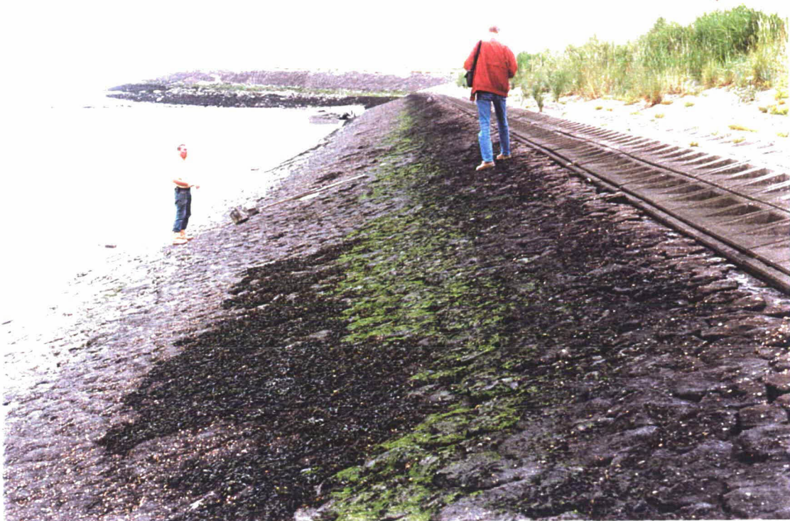
Foto 11 Overzichtsfoto van bekledingsvak 38901. Hier en daar zitten plekken met blaaswier. Op die plekken is de infiltratie grotendeels verdwenen.
