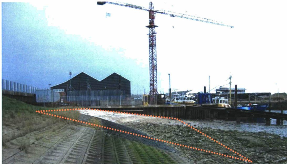
Foto 1: huidige situatie van projectgebied (oranje) ten zuiden van de scheepswerf te Bruinisse
