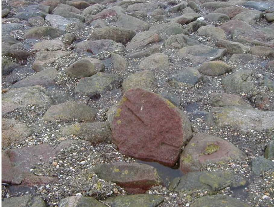
Foto 2.3. Uitstekende steen bij hmp 5,67. Mogelijke schadelocatie in 1976.
