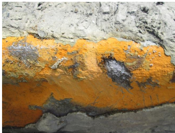
Detailfoto ter plaatse van 1 meter boven de onderkant van de plank. Te zien is een lichtbruin gekleurd grondlaagje, omgeven door een gebied met een dikke grondlaag. In het midden van de lichtbruine laag is het grondlaagje weggekrabt en komt het staaloppervlak tevoorschijn.
