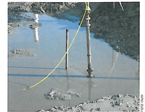
Hydraulisch aanbrengen van het versterkt sediment met statische in-line menger. De gele slang is de waterglastoever.
