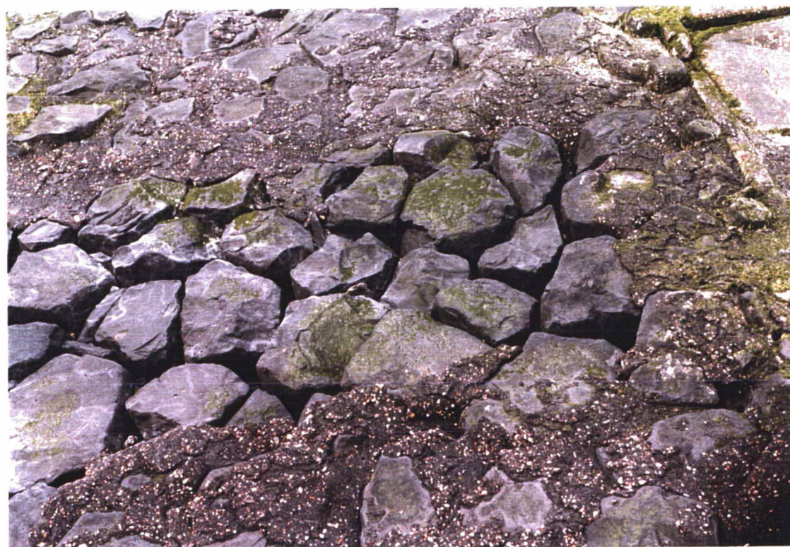
Foto 18 De naden tussen de zuilen zijn leeggespoeld (km 16,9).
