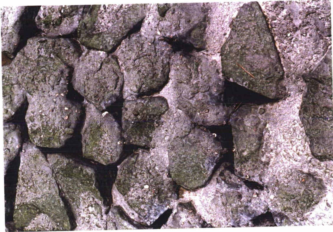
Foto 11 Onder de blokken heeft uitspoeling plaatsgevonden (km 16,3).
