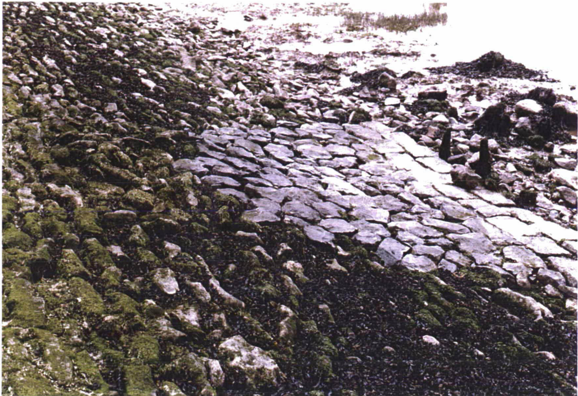
Foto 7 Hier is kennelijk een schade in de Vilvoordse steen gerepareerd (km 15,7)
