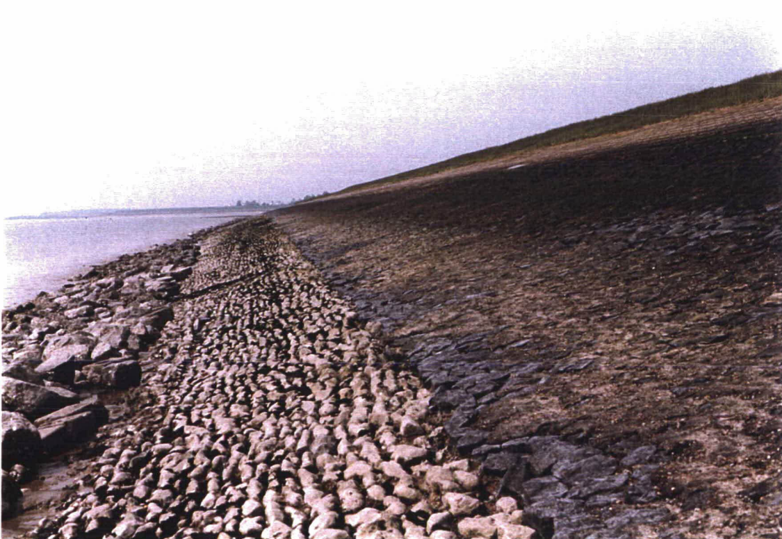
Foto 24 Overzicht van het vak waar de penetratie asfalt blijkt te zijn in plaats van beton (km 17,6, foto genomen in westelijke richting).
