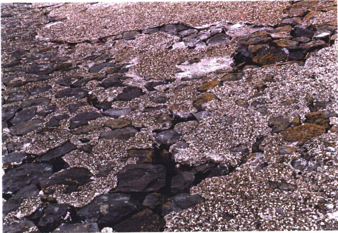
Foto 19 Beeld van de betonpenetratie, en de kale plekken daarin (km 17,3).
