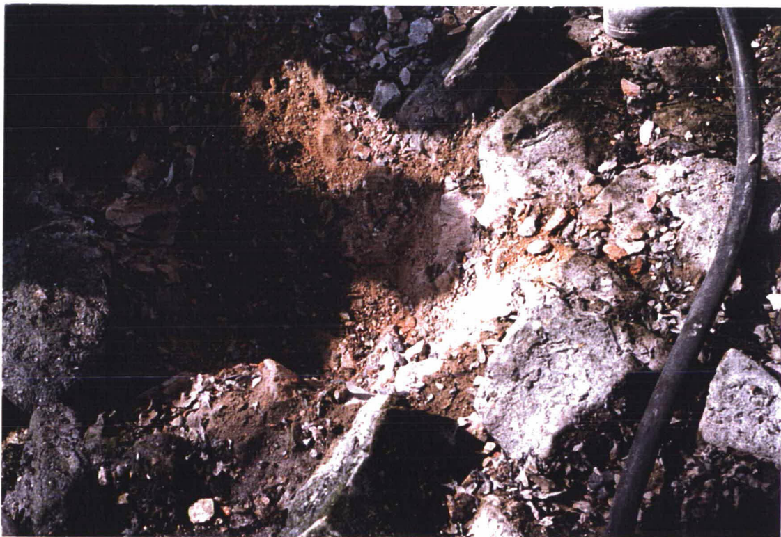
Foto 2 Gat in de overlaging bij km 15.
