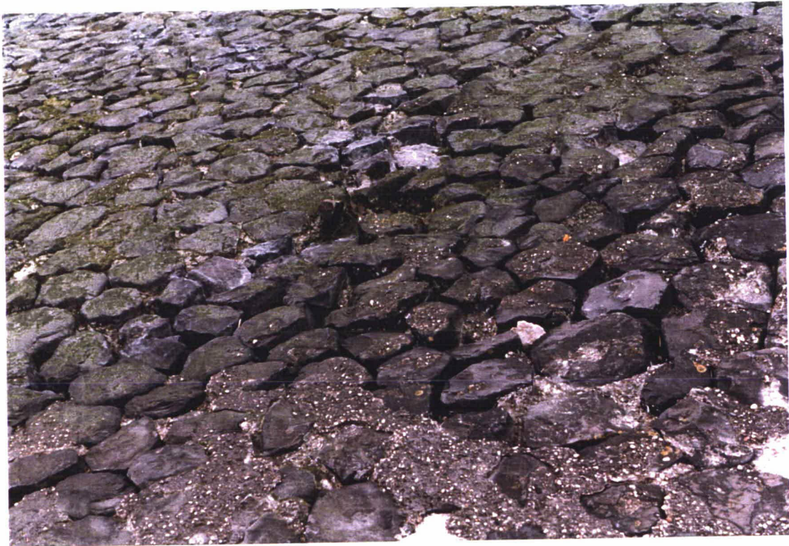
Foto 20 Verzakking van een deel van het talud (km 17,3).
