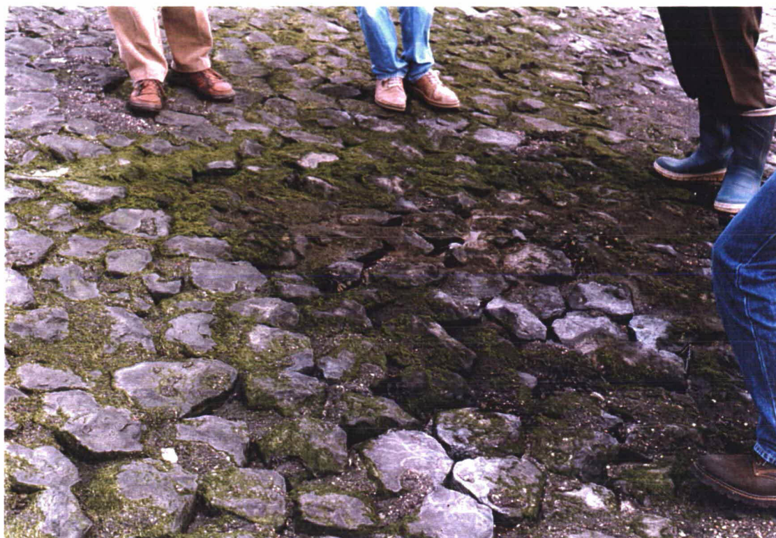
Foto 17: Een deuk in het talud (km 16,9).
