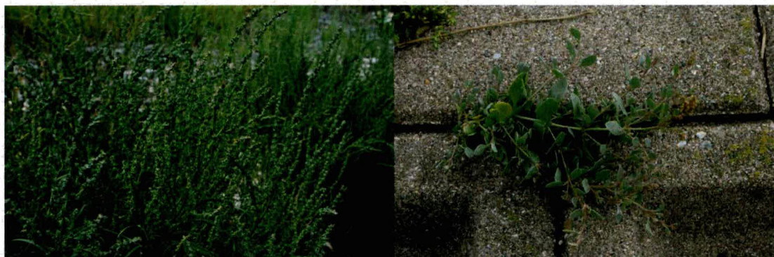
Foto 4.3: Zoutplanten (klein schorrenkruid en gewone zoutmelde) op de steenbekleding van het dijktraject Karelpolder Nieuwlandepolder.
