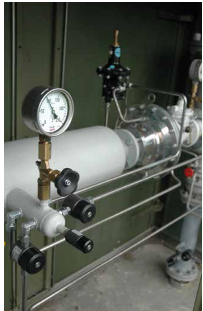
Foto 4.6 Voorbeeld van aangebrachte systeemkoppelingen
