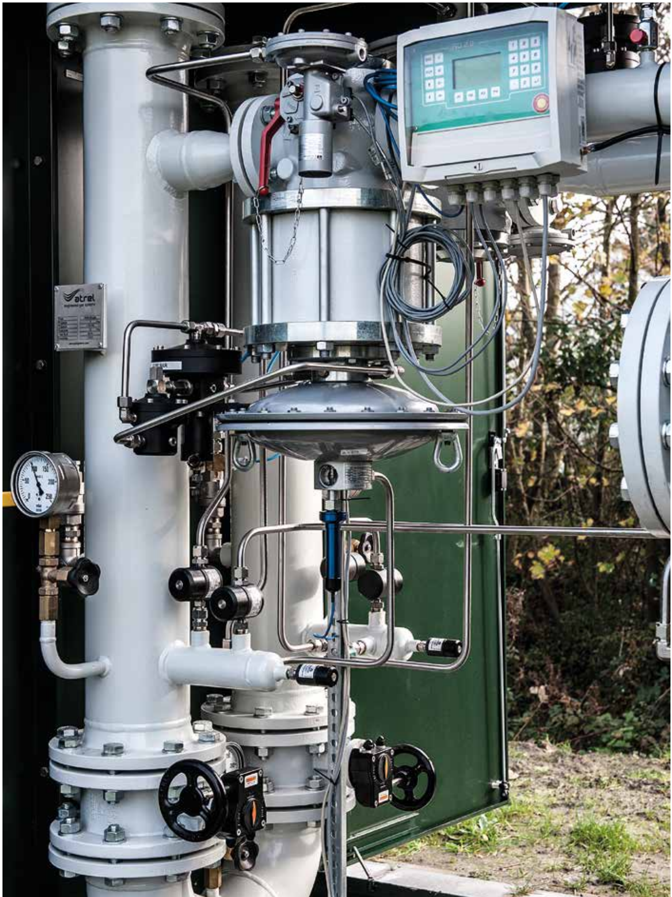
Foto 4.8 Realisatie bedrijfsmeting met behulp van FIO technologie bij DRS Blankersweg in nabijheid van recreatiepark Den Osse in Brouwershaven
