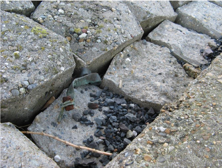
Figuur 3.8 Basalton, waarbij aan de teen van het talud de koppen van de zuilen zijn gesprongen door te grote normaalkracht in het vlak van de zetting
