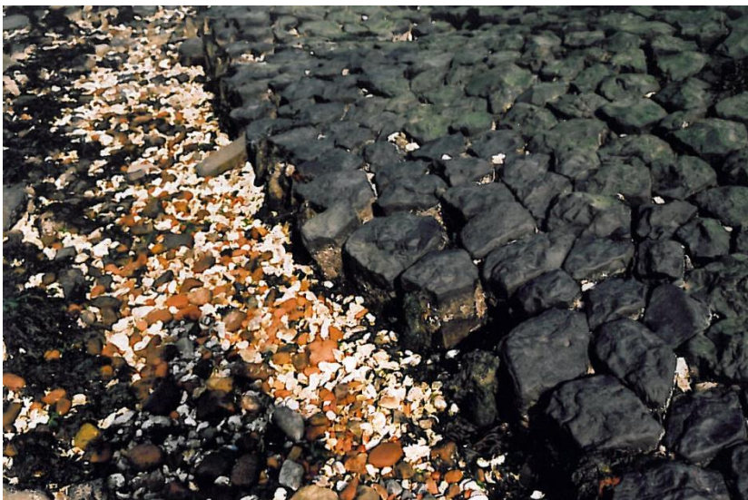
Figuur 1.1 Voorbeeld van ernstige schade aan teenconstructies
