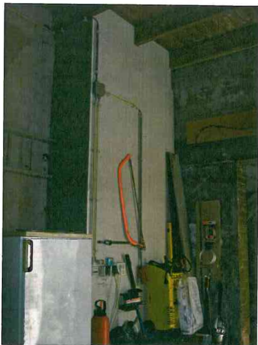
Foto 2131: bron 1, plaat tegen achterzijde meterkast in wachthuis
