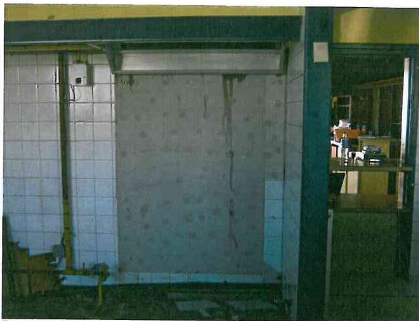
Foto 2157: bron 4, plaat tegen muur in keuken, paviljoen
