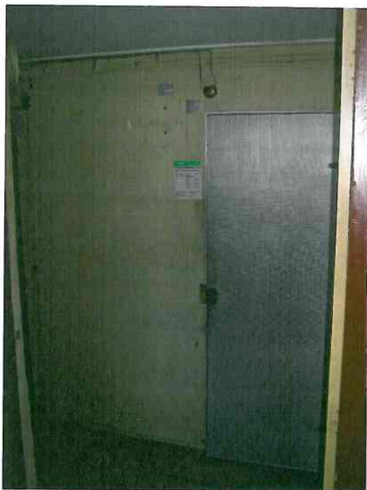
Foto 2155: aanzicht koelcel met toegangsdeur, paviljoen
