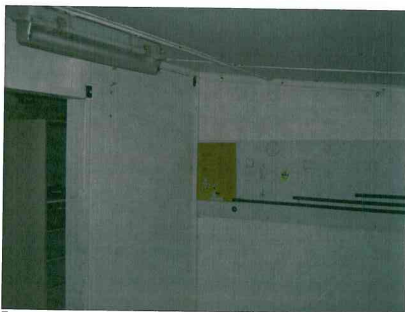
Foto 2154: wand- en plafondbeplating in koelcel, paviljoen
