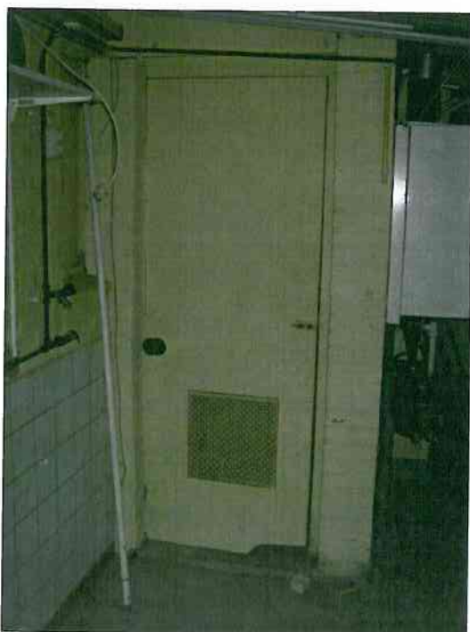
Foto 2146: bron 2, plaat op deur voormalige c.v.-ruimte paviljoen
