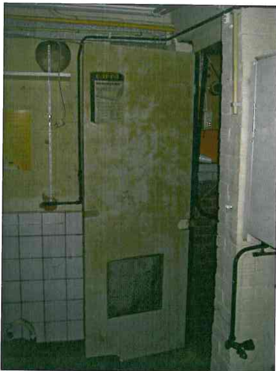
Foto 2147: bron 2, plaat op deur voormalige c.v.-ruimte paviljoen
