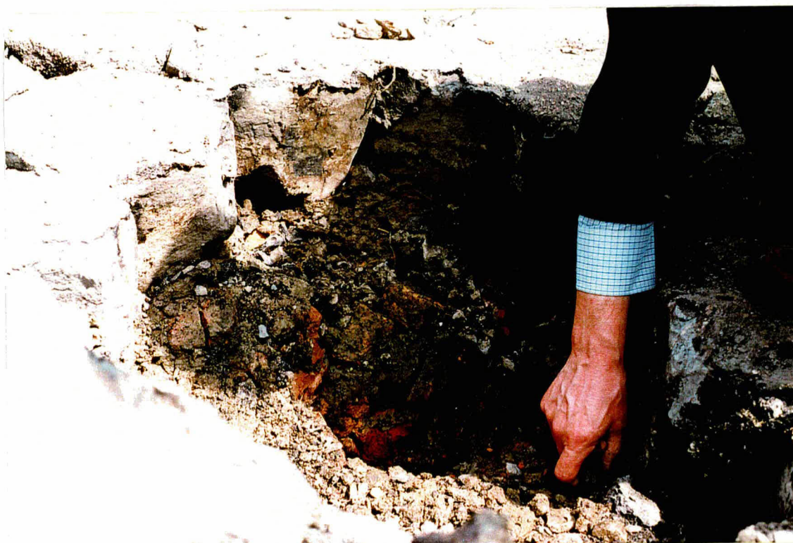
Foto 4 Voorbeeld van overgoten basaltzetting. Het filter hieronder is ingezand. Onder de blokken en tussen de blokken lijkt nog wat holle ruimte te zitten.
