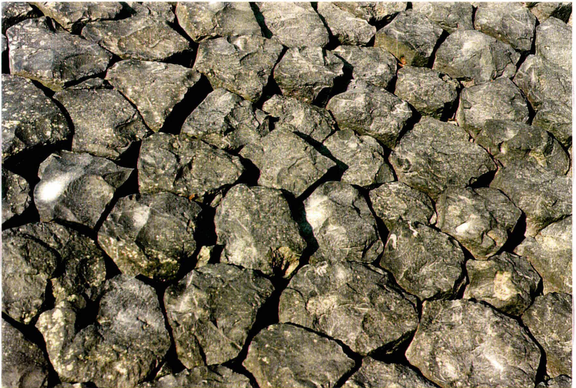
Foto 5 Voorbeeld van een plaats waar circa 1 m 2 zuilen zijn verzakt.
