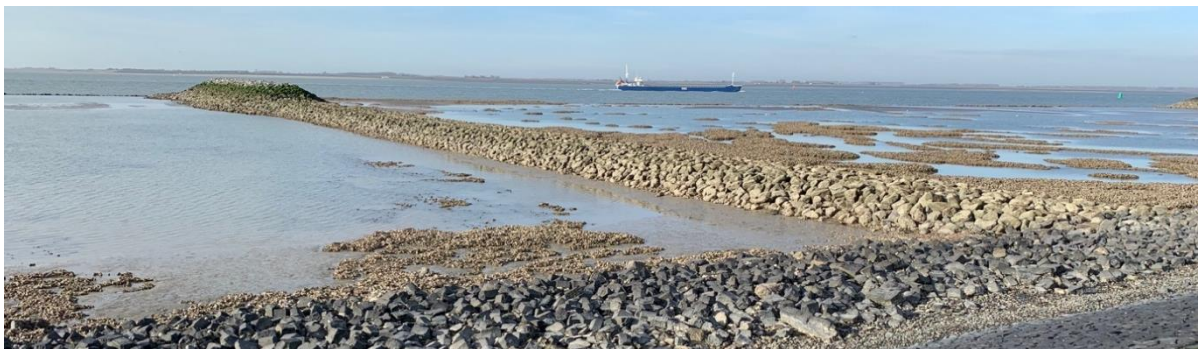
Figuur 156. Eén van de strekdammen met een HVP bij locatie Knuitershoek. Foto: J. Rozinga.
