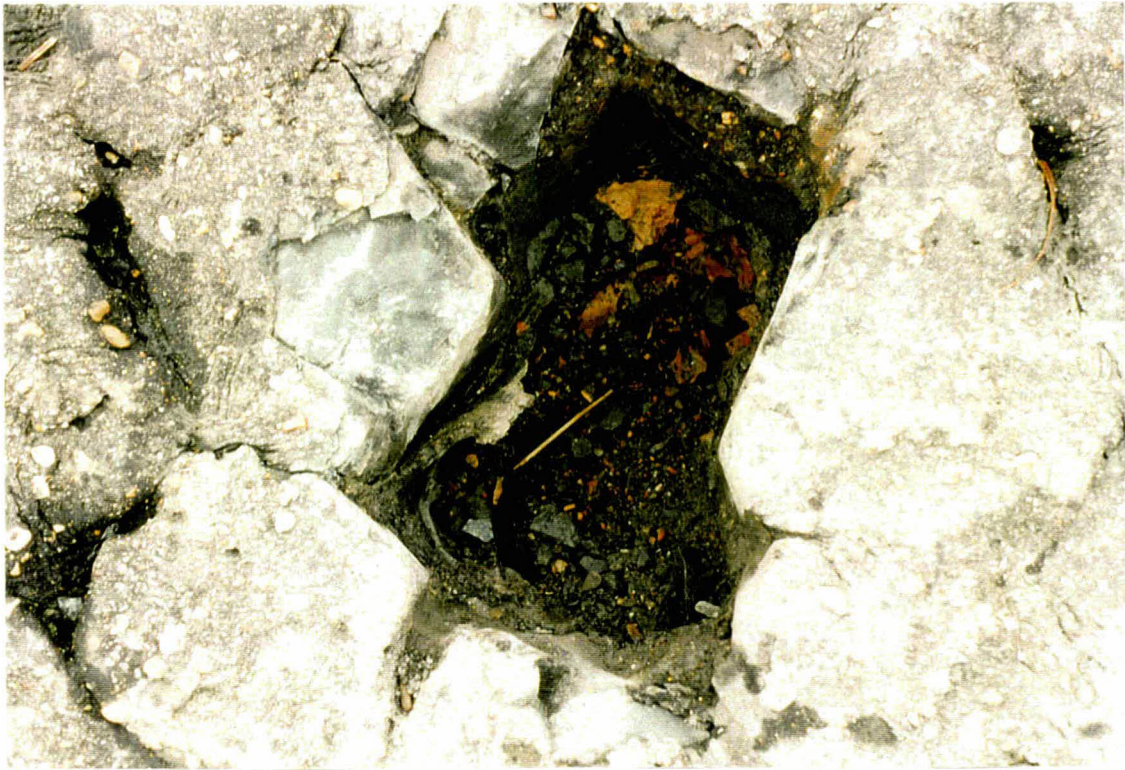
Foto 35 Gat in bekleding 18604 bij km 18,85. Er is een dun ingezand filter aanwezig.
