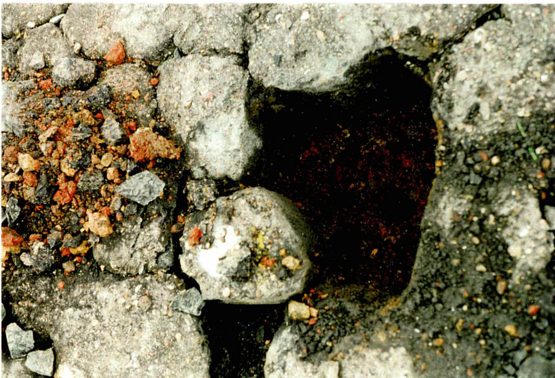
Foto 32 Gat in bekleding 18604 bij km 19. Ingezand filter. De penetratie is tot onderin de spleten aanwezig.
