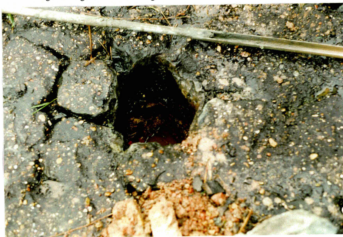
Foto 22 Gat in bekleding 19201 bij km 19,4 hoog op het talud. Het dunne puinfilter oogt wel ingezand, maar er blijkt toch een grote doorlatendheid aanwezig te zijn.
