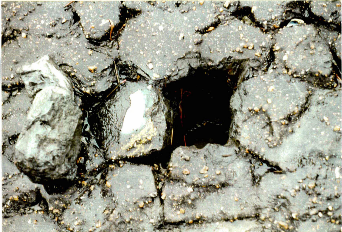
Foto 17 Gat in bekleding 19402 bij km 19,6. In het gat op ongeveer NAP + 3 m staat nog water, hoewel er al uren geen water meer op het talud staat.
