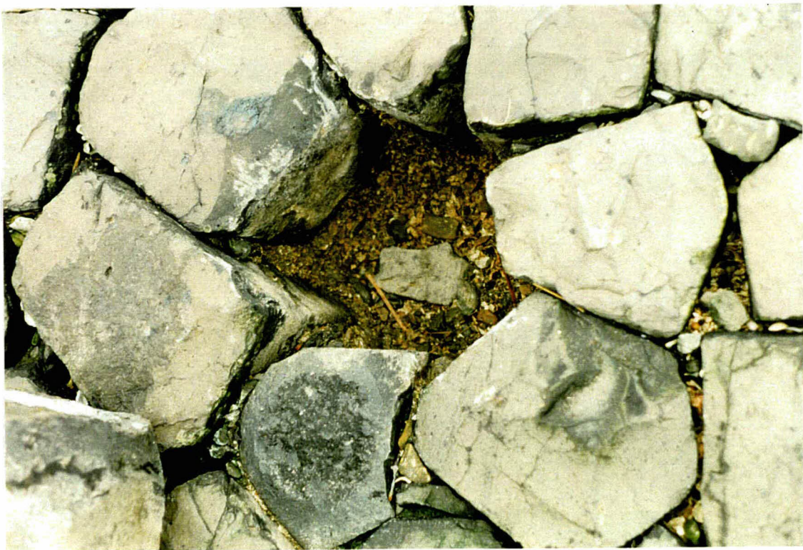
Foto 38 Bekleding 18604. Op het niet geopeneteerde stuk lijkt nauwelijks een filter aanwezig. Het filter is ondoorlatend: water dat in het gat wordt gezet zakt nauwelijks.
