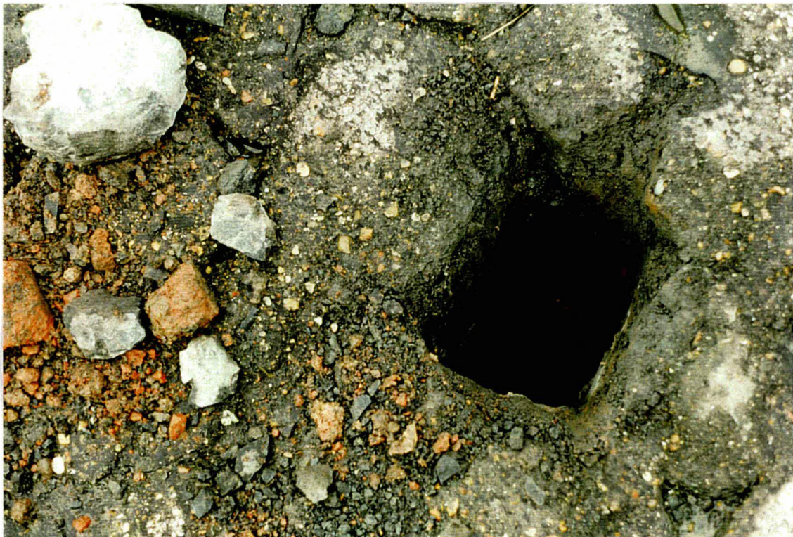
Foto 30 Gat in bekleding 18604 bij km 19,15. De penetratie is tot onderin aanwezig.
