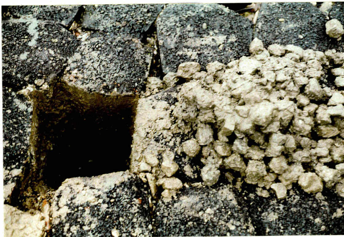
Foto 8 Gat in het basalt. Het basalt is 25 cm dik en dichtgeslibd. Onder de basalt zit een dun laagje fijner filter, en een dikke laag grove steenslag.
