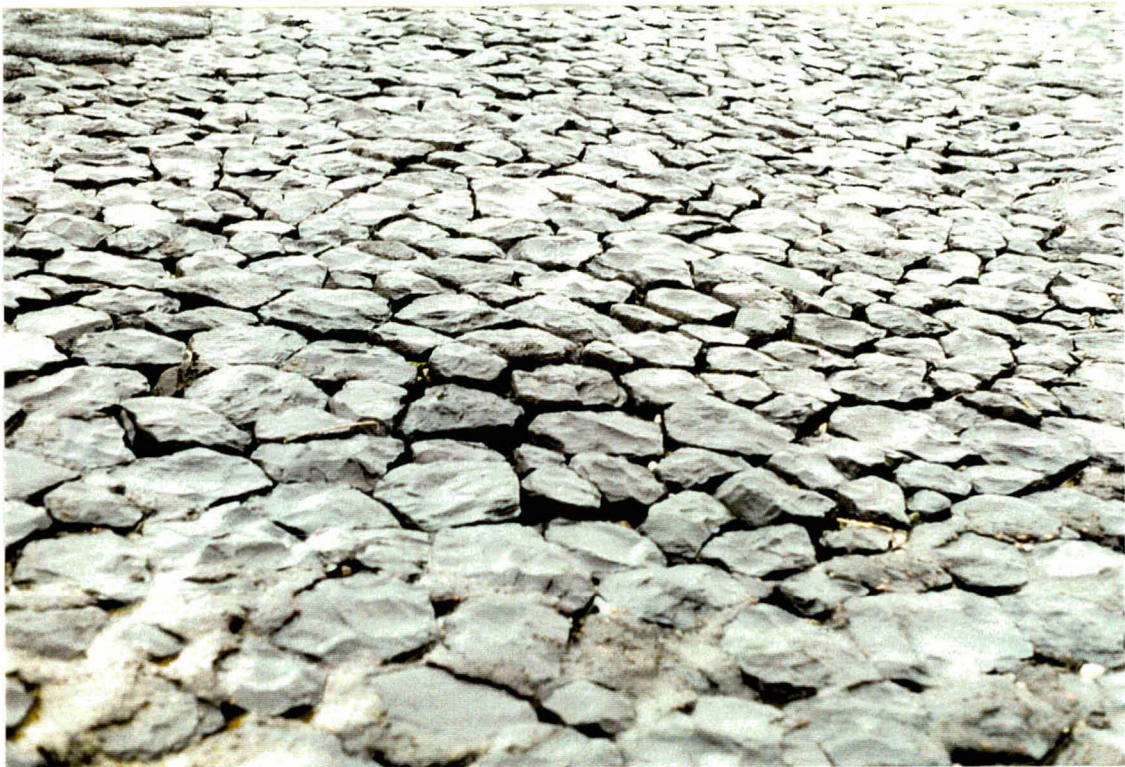
Foto 18 Bekleding 19402 bij km 19,55. Er zit een deuk in het talud. De penetratie lijkt goeddeels verdwenen.
