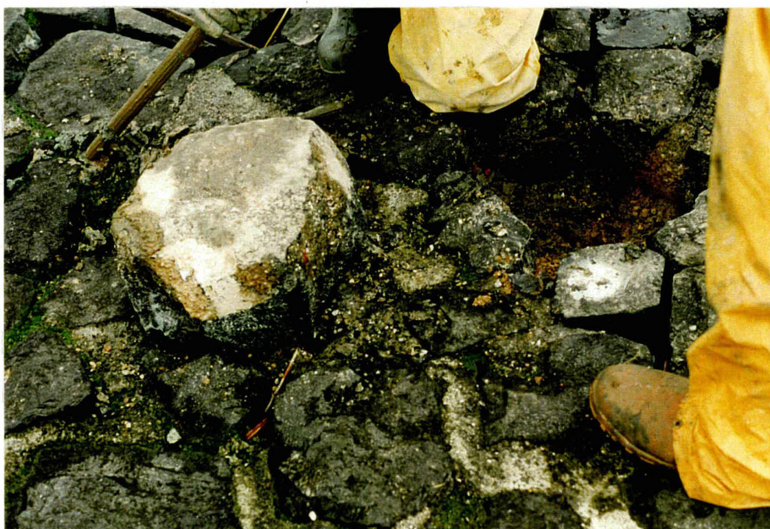
Foto 28 Gat in bekleding 18901 bij km 19,15. In het gat is nauwelijks penetratie zichtbaar.
