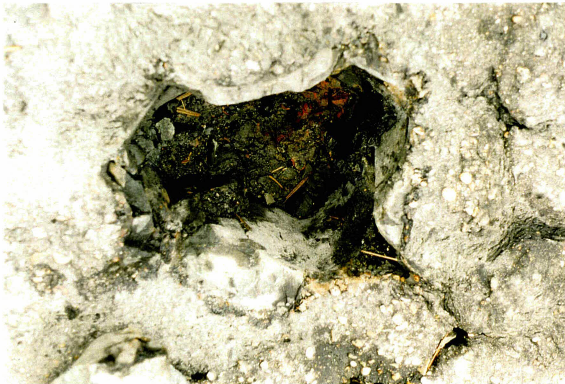
Foto 36 Gat in bekleding 18604 bij km 18,7. Ook hier een dun ingezand filter. De penetratie is goed tussen de spleten doorgedrongen.
