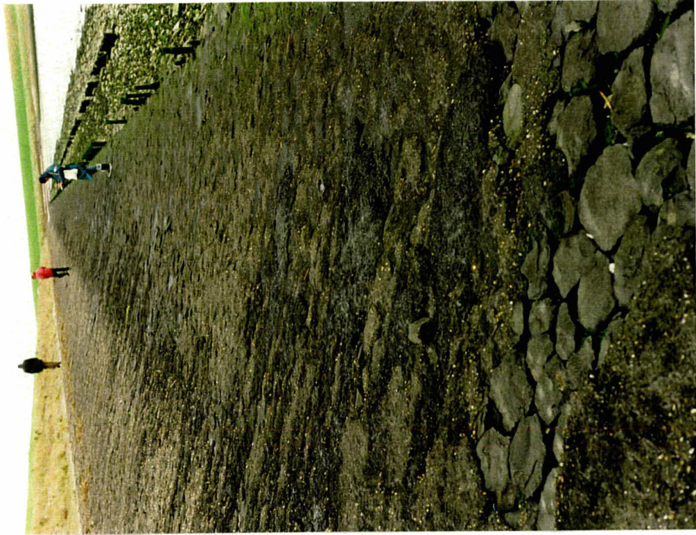
Foto 33 Overzicht van de bekleding 18604 bij km 18,9. Hier is de asfaltpenetratie over grotere hoogte aanwezig.
