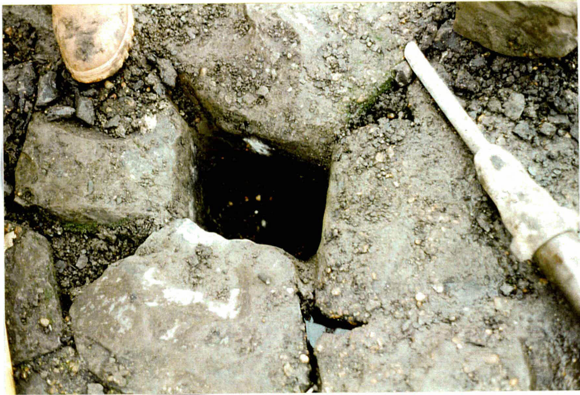
Foto 13 Gat in gepentereerde basalt in vak 21512 bij km 21,7. De asfalt zit tot in het filter.
