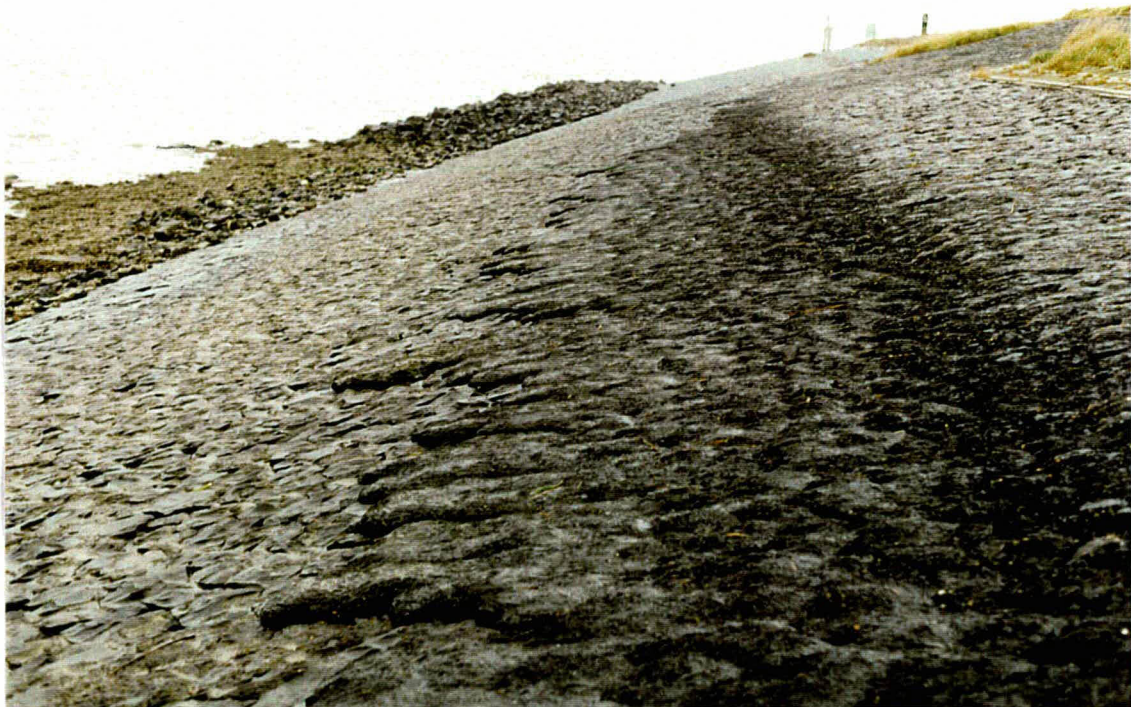
Foto 14 In het begin van vak 19402 is de basalt over grotere hoogte gepentreed dan in de rest van het vak. Het achterste deel van de dijk op deze foto bestaat uit de strekdam bij de veerhaven
