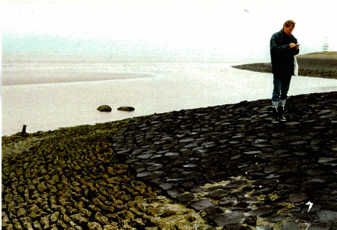
Foto 1 Basalt, bekledingnummer 22503, in de bocht richting de strekdam. Onder de basalt zit met beton geopenetreerde Vilvoordse steen
