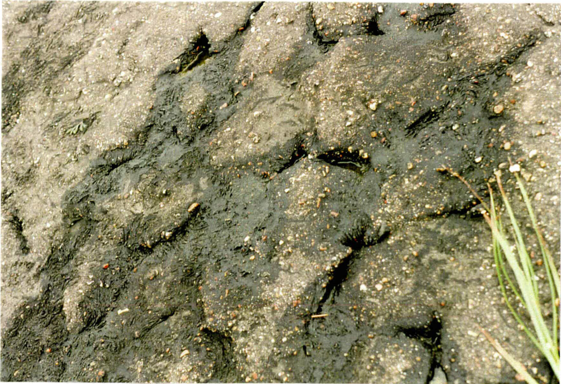
Foto 31 Bekleding 18604: in de bekleding zitten vochtplekken die op enige doorlatendheid van de toplaag duiden.
