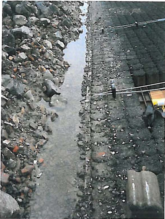
Foto 5: Vervorming van de teenconstructie onder belasting
