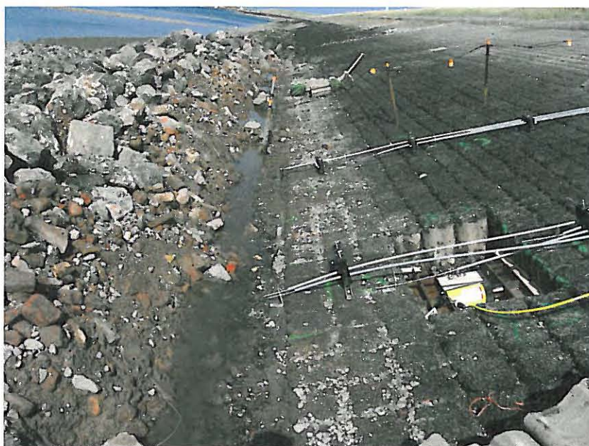
Figuur 3 Foto meetlocatie bij Sluis met twee clusters met verplaatsingsopnemers en op de achtergrond de opstelling van de waterspanningsmeters
