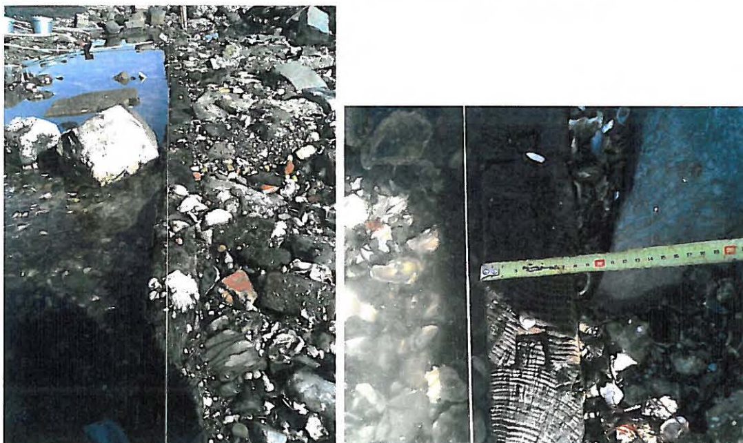
Figuur 7 Foto's vervorming teenschot na belasting, het koord bevindt zich aan het begin en aan het einde centraal ten opzicht van het teenschot. In het midden is de verplaatsing van het 8 cm dikke houten schot circa 5 cm
