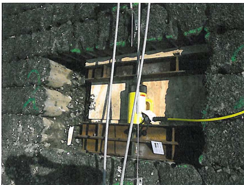
Figuur 5 Vijzel met stalen balkjes in gat in toplaag bestaande uit 40 cm hoge Hydroblocks
