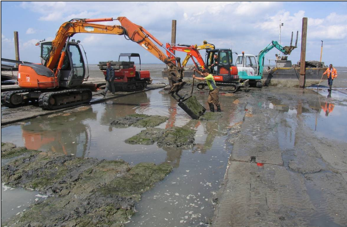
Foto 2: Werkzaamheden op mitigatielocatie Roelshoek, 8 juni 2011 Let op de draglineschotten (links en rechts) en de ponton voor het materieel (achteraan)
