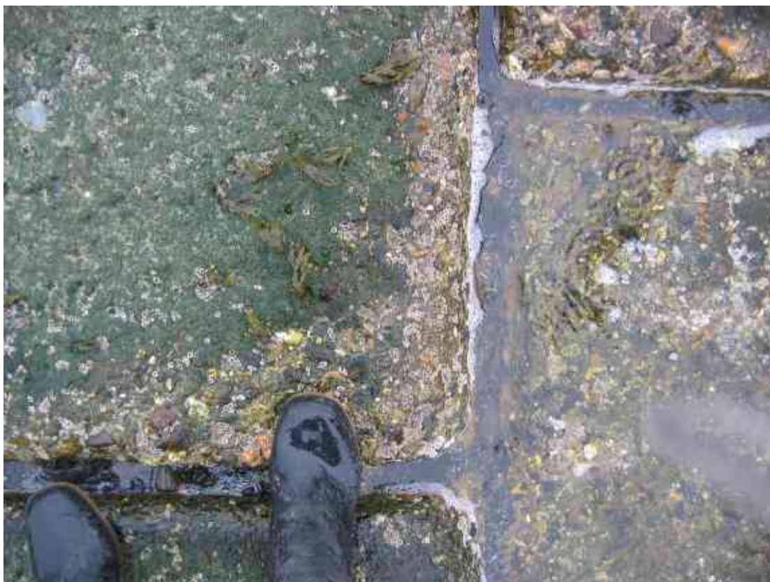
Foto 3.10. Verzakking van betonblokken (3 ton) op zeewering Westkapelle produceert vanzelf biologisch interessante poeltjes. Dit effect kan worden versterkt.
