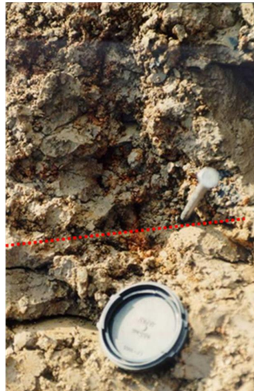
Figuur 4.1 De onderste helft van de foto, beneden de spijker, is het met bulldozer verdichte deel van (dikte ongeveer 0,15 m) van een opgebrachte kleilaag, een slag met een dikte van 0,4 m. De bovenste helft van de foto is de onderkant van de daarop gelegen, volgende slag klei met een dikte van 0,4 m dikte. Ook die slag is verdicht met bulldozer overgangen, maar, zoals te zien, is de onderste helft van de slag niet verdicht
