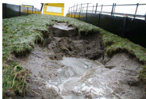
Figuur 3.2 Schade door overslag tijdens een proef met de overslagsimulator. (Rijkswaterstaat, 2012). De schade ontwikkelt zich voornamelijk door het langs de helling naar boven verplaatsen van de steile achterwand, wat in dit geval wordt versterkt door het wegspoelen van zand voor de kleibekleding.
