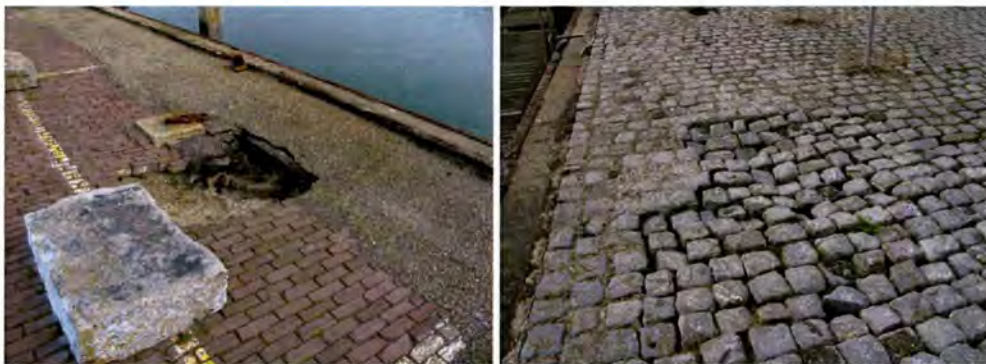
Figuur 2.5 Verzakkingen bestrating haventerrein
