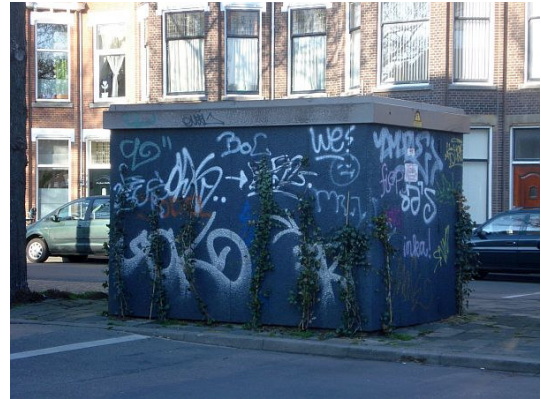
Transformatorhuisje in Den Haag
