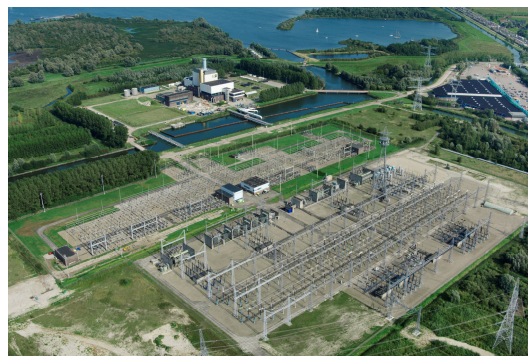
Verdeelstation centrale Diemen
