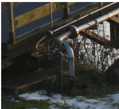
Figuur 16 Leidingen steigers manifold
