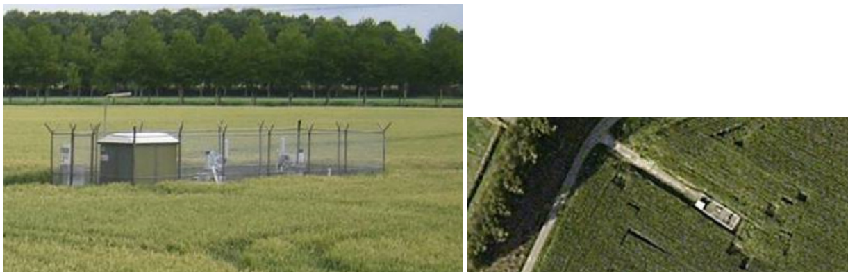
Figuur 3 Gasinstallatie Gasunie (ID 45.20)
