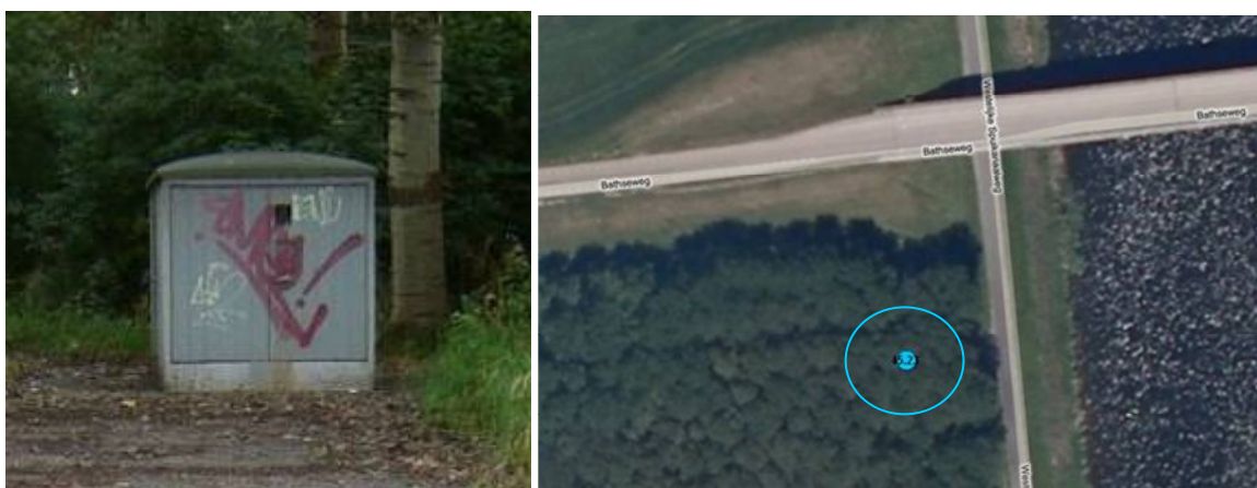
Figuur 19 Transformatorhuisje DNWB, ten Zuiden van Bathseweg (zie ook Figuur 36, Figuur 38, bijlage 2)
