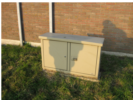
Figuur 23 Object nabij transformatorhuisje Princesseplaat (ID 27.02)
