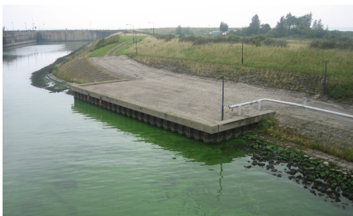
Figuur 18 Aansluitpunt met opstelplateau van noordelijke brandblusinstallatie Krammersluizen
