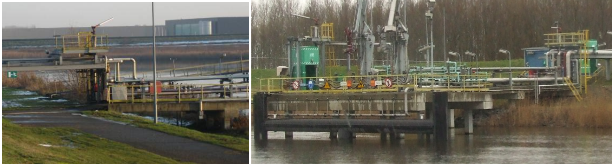
Figuur 15 Situatie manifold Sabic
