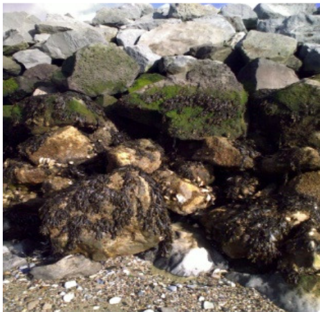
Figuur 40; Stortstenen (oude dijkbekleding) Stortstenen zijn oude dijkbekledingen, (natuurstenen als Vilvoordse, graniet, lessinische en doornikse steen en gebroken betonblokken) gebruikt als stortsteen op de kreukelberm.
