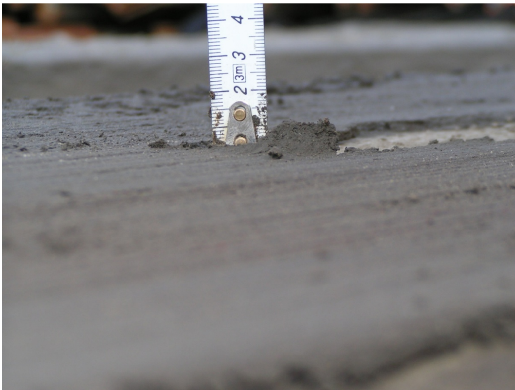
Foto 2-1 Voorbeeld aanhangende grond bij verwijderen Spanwand.
