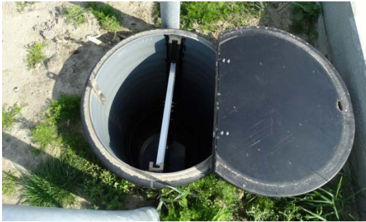
Figuur 2.3 Foto van een regelput met stuwplankje.
